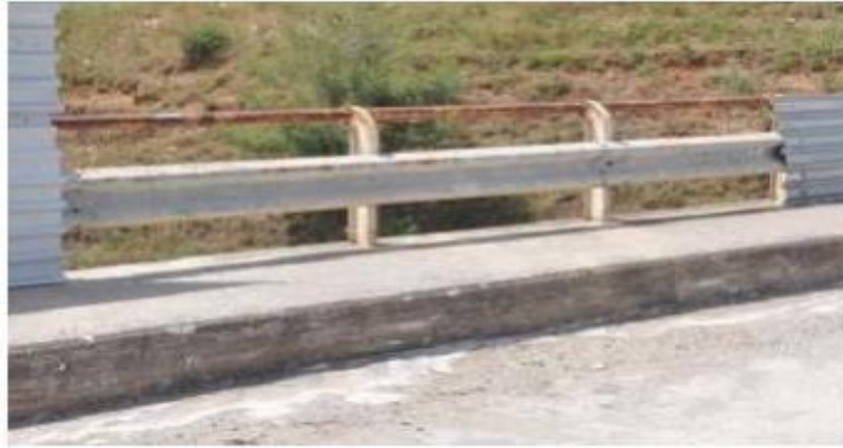
Σχήμα 3- 16 Υφιστάμενο στηθαίο ασφαλείας (προς αντικατάσταση).
