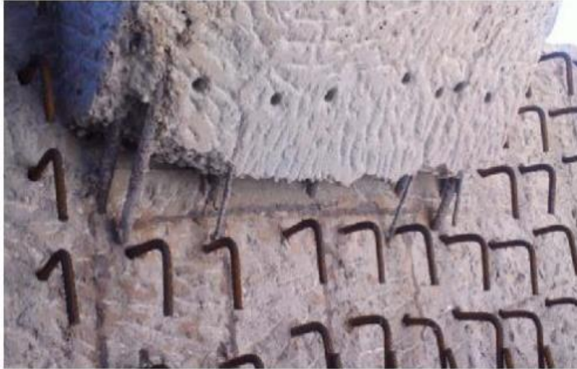
Σχήμα 3- 12 Προετοιμασία πέδινων για σκυροδέτηση του επιπλέον πάχους τους (τοποθέτηση οπλισμού σύνδεσης υφιστάμενου με νέο σκυρόδεμα).
