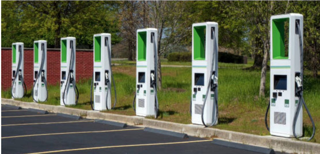
Εικόνα 3.2: Φορτιστές ηλεκτρικών οχημάτων
