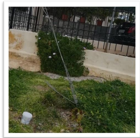
Εικόνα 1.8 : Επίτονο αγκυρωμένο στο έδαφος [54]
