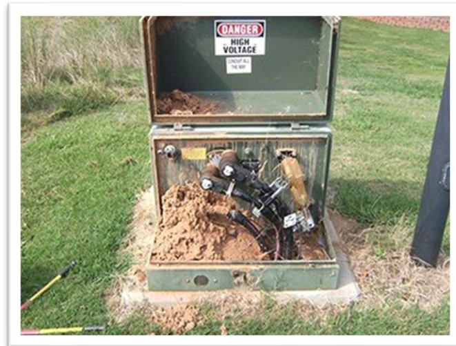
Εικόνα 1.14: Φωλιά μυρμηγκιών σε μετασχηματιστή [15] .
