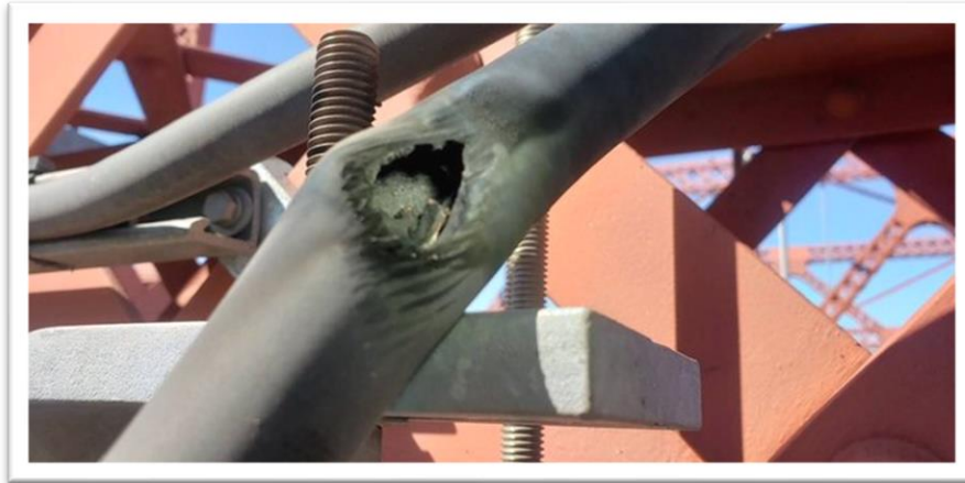
Εικόνα 4.3 : Λιώσιμο καλωδίου λόγω υψηλής θερμοκρασίας.
