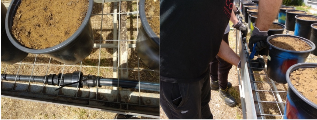
Εικόνα 35: Ο κύριος αγωγός με μια από τις βάνες Εικόνα 36: Δημιουργία τρυπών με τη σγρόμπια
