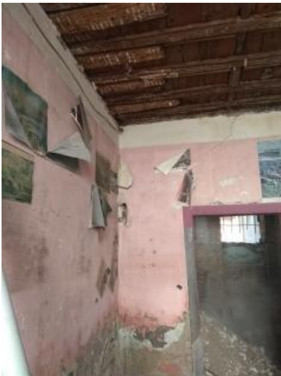
Εικόνα 36. Εικόνα του επιχρίσματος εσωτερικά του κτηρίου στο επίπεδο του ισογείου
