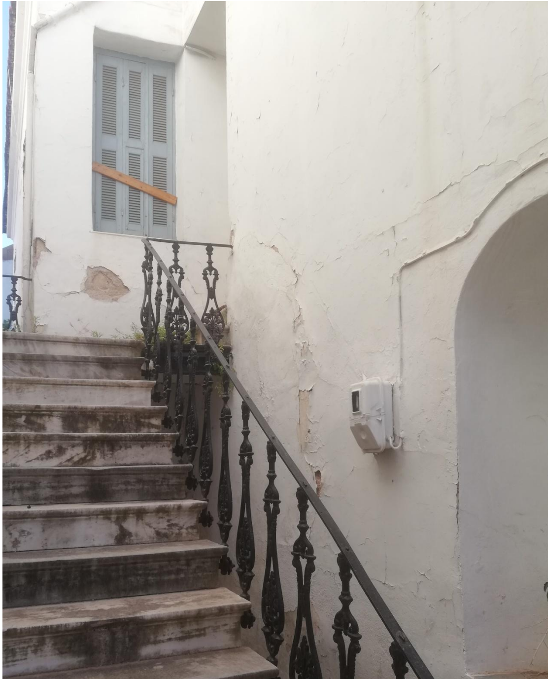
Εικόνα 37. Κατάσταση διατήρησης των επιχρισμάτων πριν γίνει εξ' ολοκλήρου καθαίρεση του
