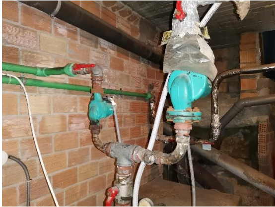
Εικόνα 2.24: Κυκλοφορητές Wilo Λουτήρων(αριστερά) και Πισίνας (δεξιά)
