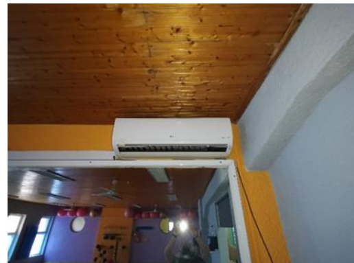
Εικόνα 2.12: Κλιματιστικό LG – 12,000 BTU/h
