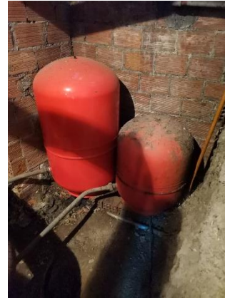
Εικόνα 2.25: Δοχείο διαστολής κυκλώματος Λουτήρων και Πισίνας
