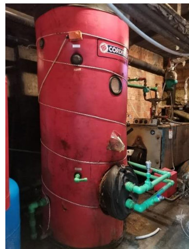
Εικόνα 2.23: Θερμικό δοχείο αδρανείας (Boiler)-800lit
