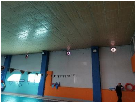
Εικόνα 2.15: Ανεμιστήρες ανανέωσης αέρα χώρου πισίνας (5x0.5kW)
