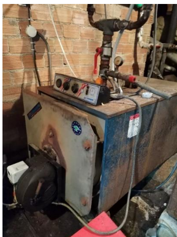
Εικόνα 2.22: Καυστήρας ΛΕΒΗΘΕΡΜ 180Mcal/h
