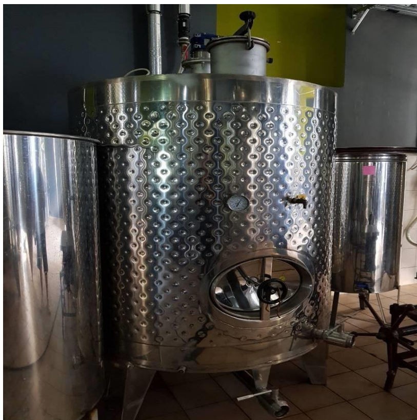
Εικόνα 3-10: Δεξαμενή αποθήκευσης και ανάδευσης κρασιού 2tn
