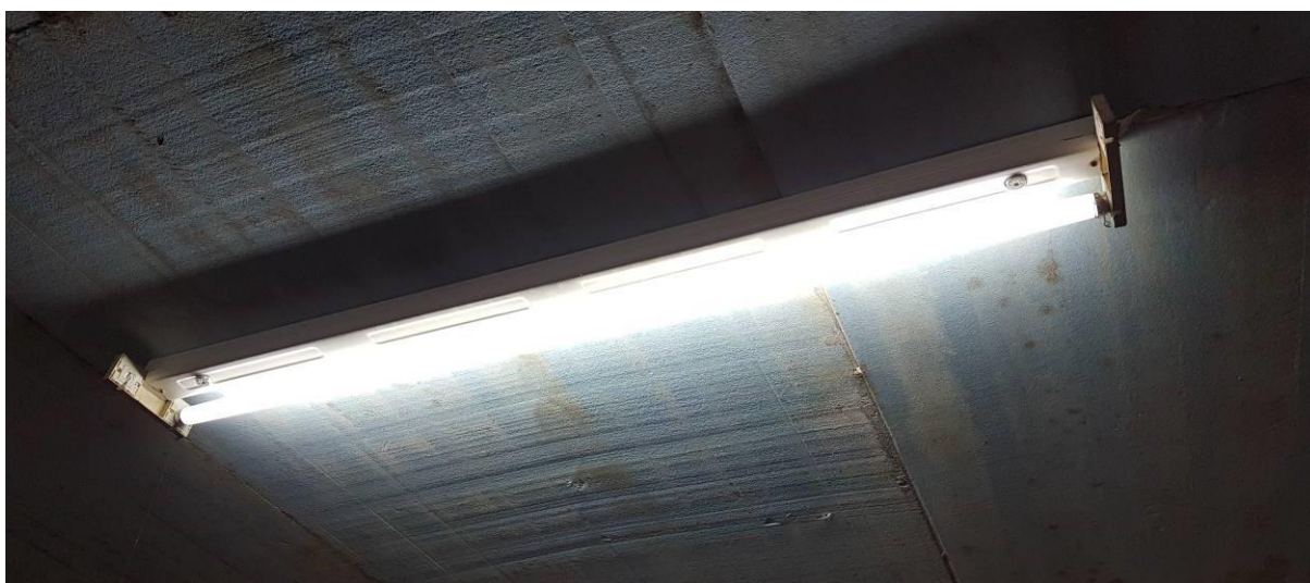
Εικόνα 3-3: Φώτα Φθορίου (Αποθήκη)
