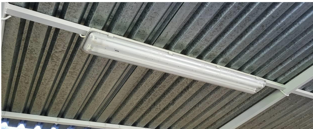
Εικόνα 3-2: Φώτα Φθορίου (στέγαστρο)
