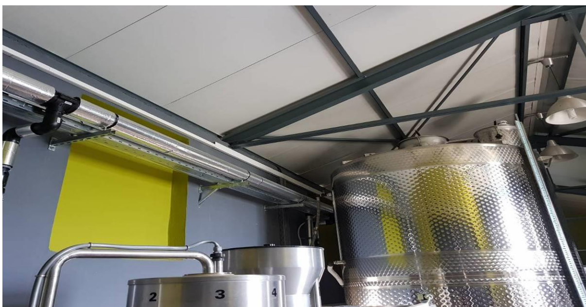
Εικόνα 3-12: Σωλήνες μεταφοράς του ψυκτικού υγρού στις δεξαμενές
