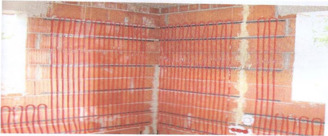
Εικόνα 3.2: Εγκατεστημένη Επιτοίχια Θέρμανση
