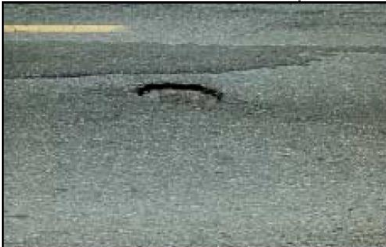
Εικόνα 23: Λακκούβα σε οδόστρωμα [10]
