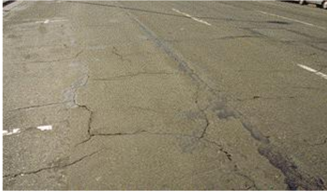
Εικόνα 15: Μεσαίας έντασης ρωγμές συρρίκνωσης [10]
