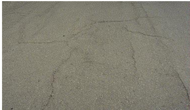
Εικόνα 14: Χαμηλής έντασης ρωγμές συρρίκνωσης [10]
