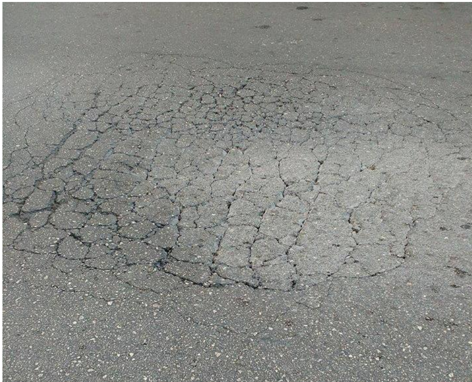
Εικόνα 8: Ρωγμές τύπου αλιγάτορα
