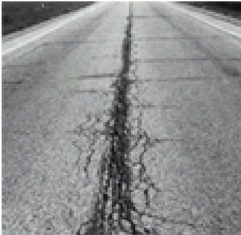
Εικόνα 13: ρωγμές μεταξύ λωρίδων διάστρωσης ή διαπλάτυνσης [10]
