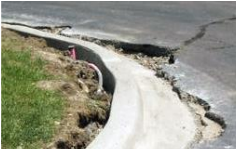
Εικόνα 11: Ρωγμές στα άκρα του οδοστρώματος( http://info.tensar.co.uk/ )
