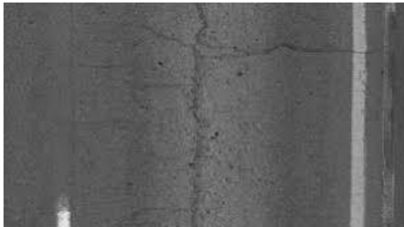
Εικόνα 10: Εγκάρσια ρωγμή ( http://info.tensar.co.uk/ )
