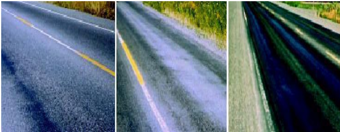
Εικόνα 24: Επίπεδα σοβαρότητας του φαινομένου ανάδυσης ή εξίδρωσης της ασφάλτου.[10]
