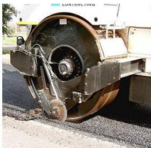
Εικόνα 30: Διαδικασία εφαρμογής ασφαλτοτάπητα με έμπηκτες ψηφίδες; Διάστρωση θερμού ασφαλτομίγματος, Διάστρωση ψηφίδων στο θερμό ασφαλτόμιγμα, Οδοστρωσία ψηφίδων, Τομή ασύνδετου υλικού στους αρμούς [16]
