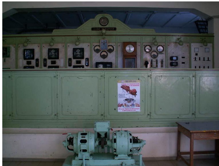
Εικόνα 6.14: Παλιός πίνακας ελέγχου
