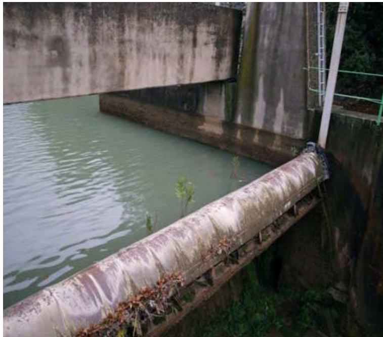
Εικόνα 6.6: Αυτόματο θυροφράγμα με αντίβαρο
