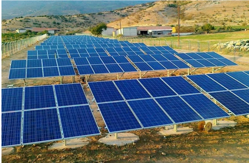
Εικόνα 25: Το φωτοβολταϊκό Πάρκο
