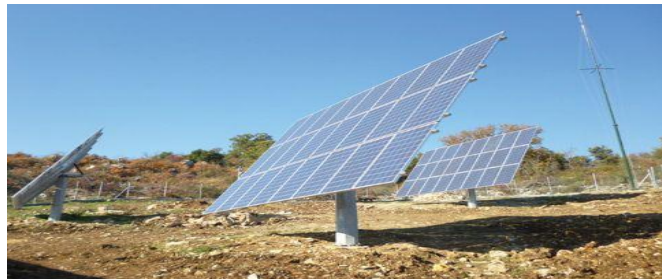
Εικόνα 31 : Φωτοβολταϊκό σύστημα τύπου tracking
