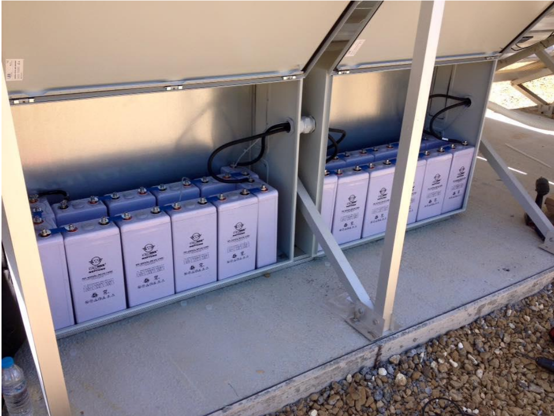
Εικόνα 33: Συστοιχία συσσωρευτών φ/β συστήματος.
