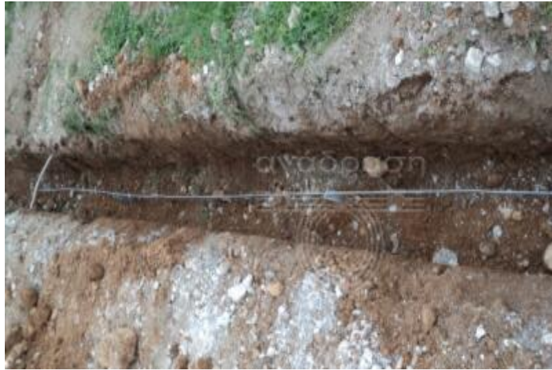
Εικόνα 3-6 Περιμετρική Γείωση Εγκατάστασης Αλεξικέραυνων Κλωβού Faraday Κτηρίου
