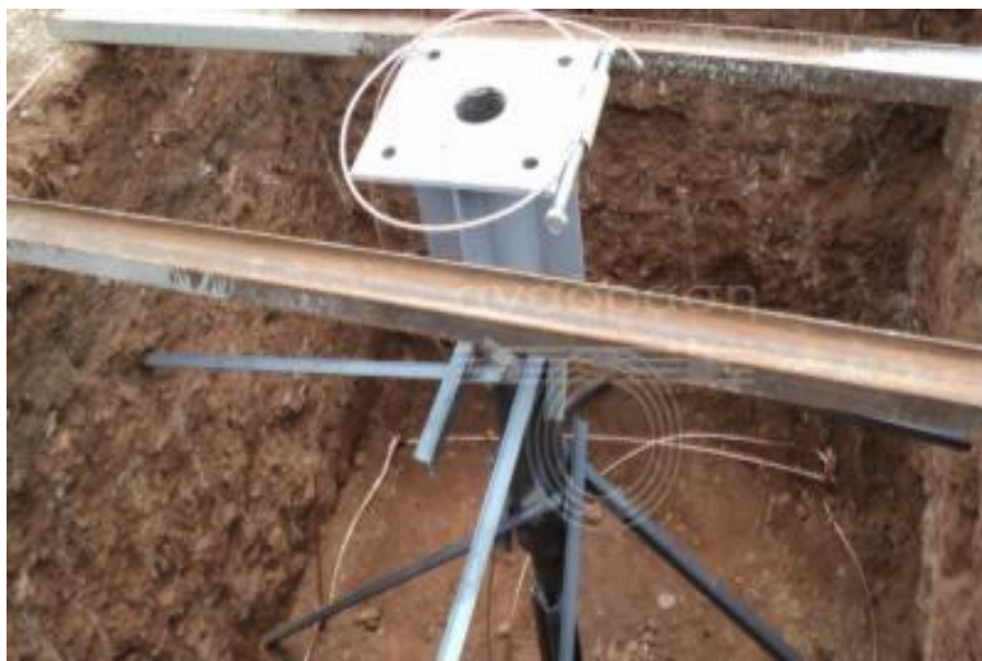
Εικόνα 3-9 Εγκαταστάσεις Αντικεραυνικών Συστημάτων Ιονισμού
