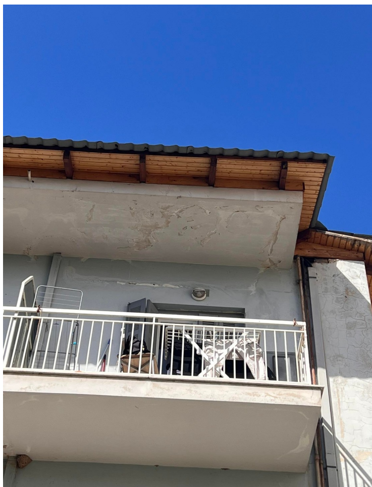
Εικόνα 9. Υγρασίες στις πλάκες των εξωστών. (πίσω όψη)
