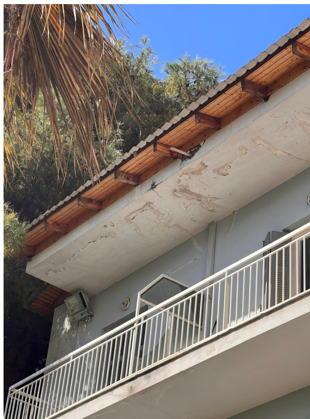
Εικόνα 11. Υγρασίες στις πλάκες των εξωστών (πίσω όψη)
