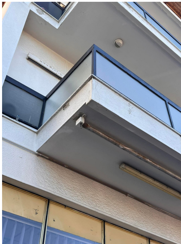
Εικόνα 8. Ρωγμές στα κούτελα των εξωστών. (πρόσοψη)
