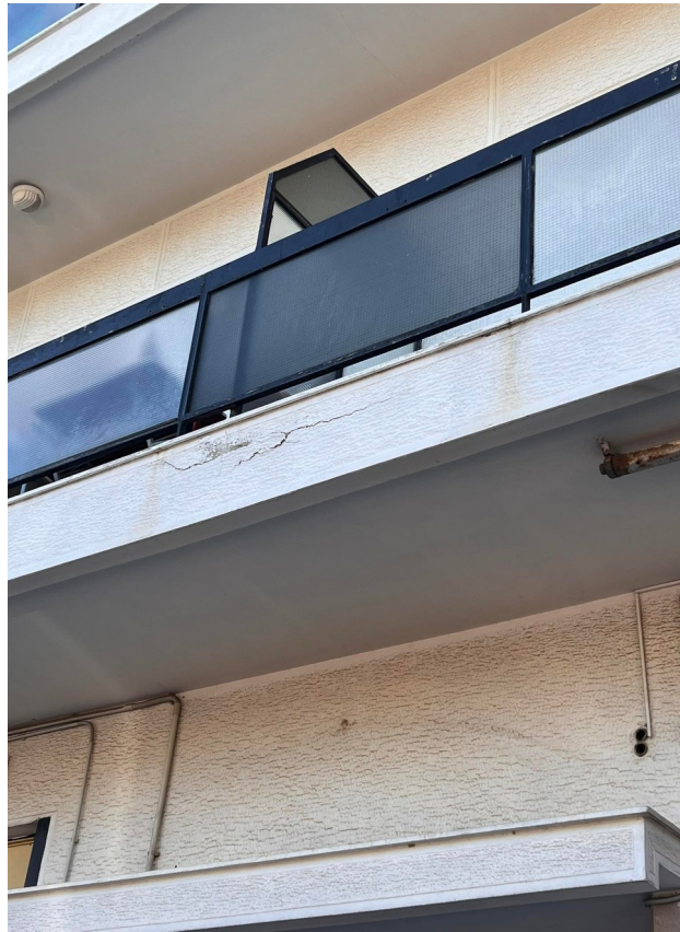
Εικόνα 7. Ρωγμές στα κούτελα των εξωστών. (πρόσοψη)
