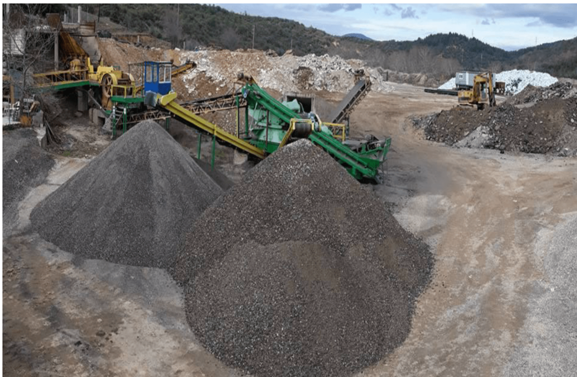
Εικόνα 8: Μονάδα επεξεργασίας – Νομός Δράμας (Ποιμενίδου, 2019)
