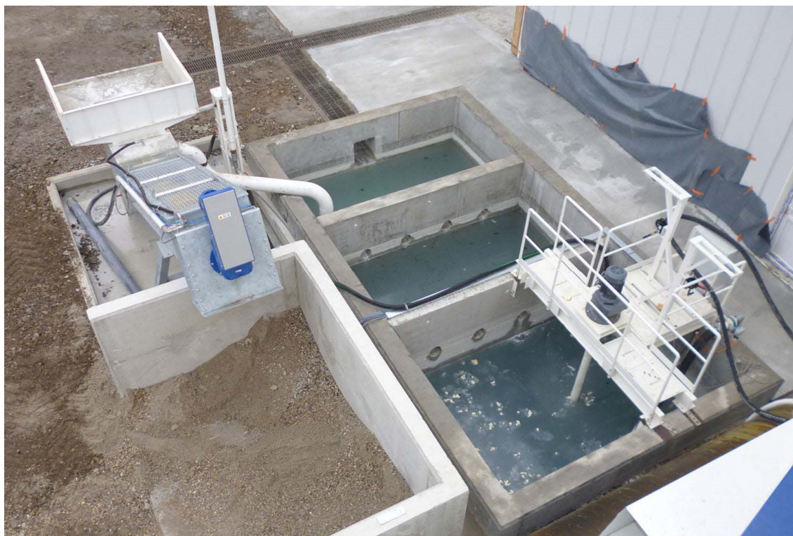
Εικόνα 1: Σύστημα ανακύκλωσης σκυροδέματος στο εξωτερικό 2021. Πηγή:( https://www.mekaglobal.com/ )
