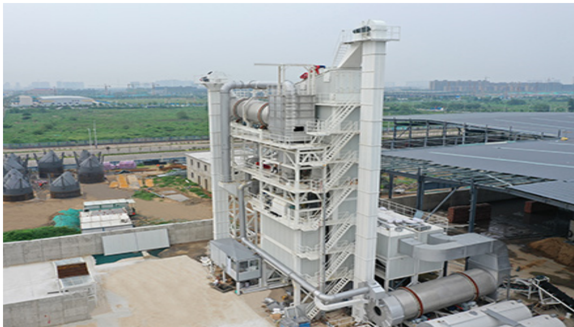
Εικόνα 5: Μονάδα ανακύκλωσης ασφάλτου στην Κίνα το 2021. Πηγή: ( https://www.zoomline.com.cn/ )
