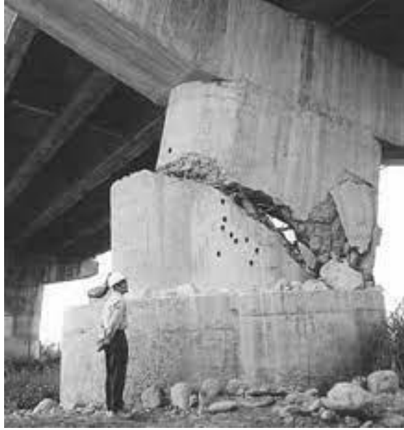
Εικόνα 34: Αστοχία διατμητικού τύπου.
