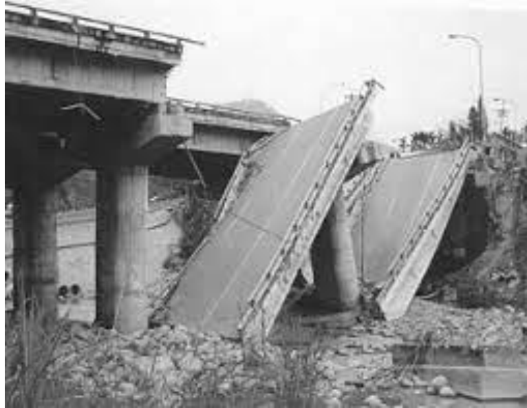
Εικόνα 32: λόγω απώλειας στήριξης Αστοχία.
