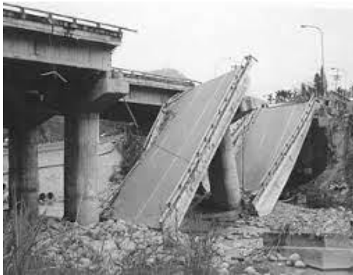
Εικόνα 35: Αστοχία ακροβάθρου λόγω ρευστοποίησης εδάφους θεμελίωσης.
