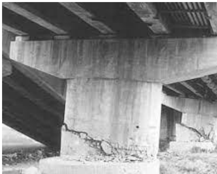
Εικόνα 33: Αστοχία καμπτικού τύπου
