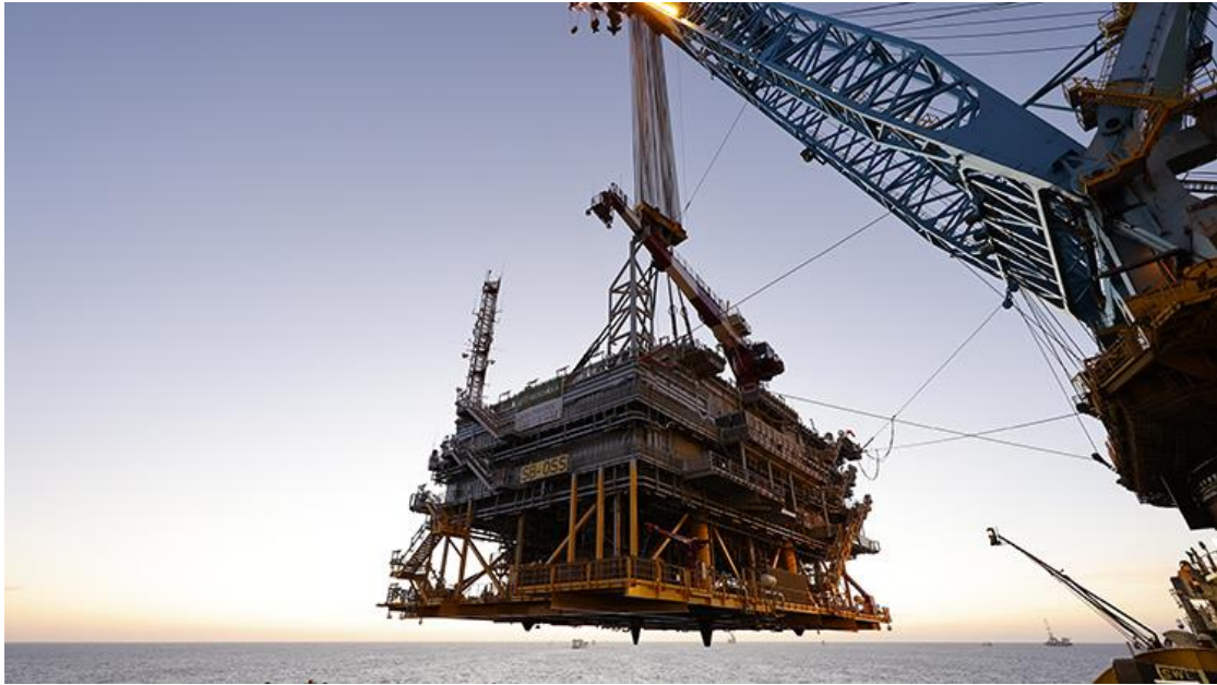
Εικόνα 4.2 Υπεράκτια εγκατάσταση του ηλεκτρικού υποσταθμού του υπεράκτιου αιολικού πάρκου Saint-Brieuc (Γαλλία), βάρους περίπου 3.400 τόνων ( https://www.iberdrola.com/about-us/our-activity/offshore-wind-energy/offshore-wind-park-construction )
