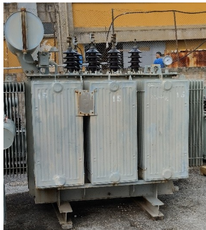
ΠΛΑΓΙΑ ΛΗΨΗ ΦΩΤΟΓΡΑΦΙΑΣ ΕΝΟΣ ΑΥΤΟΜΕΤΑΣΧΗΜΑΤΙΣΤΗ 20kV/15kV
