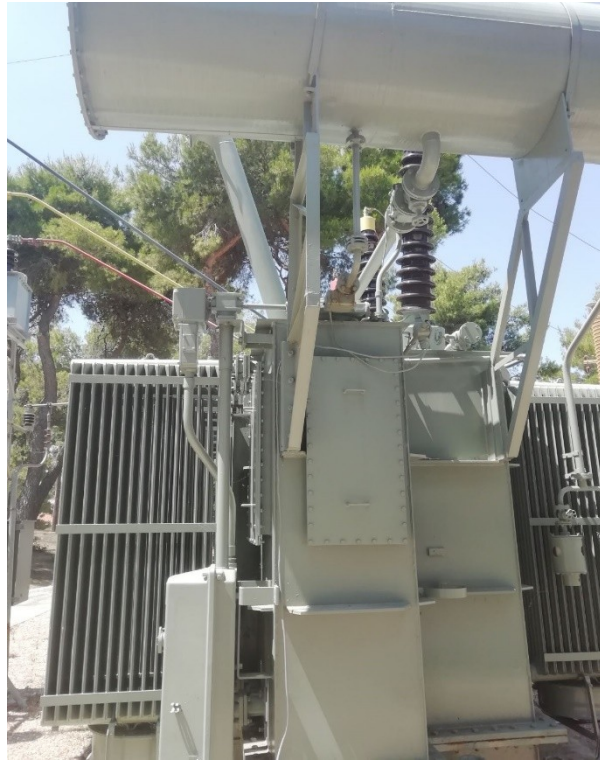
ΔΟΧΕΙΟ ΔΙΑΣΤΟΛΗΣ ΚΑΙ ΡΕΛΕ BUCHHOLZ ΜΕΤΑΣΧΗΜΑΤΙΣΤΗ ΥΨΗΛΗΣ ΤΑΣΕΩΣ
