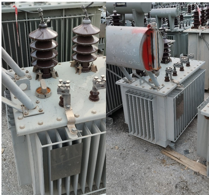
ΜΕΤΑΣΧΗΜΑΤΙΣΤΗΣ ΛΑΔΙΟΥ 160 KVA
