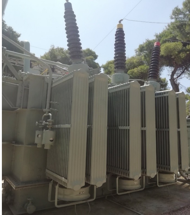
ΣΥΣΤΗΜΑ ΨΥΞΕΩΣ ΜΕΤΑΣΧΗΜΑΤΙΣΤΗ
