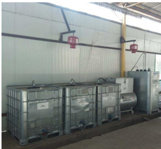
Εικόνα 4: Δεξαμενές – δοχεία προσωρινής συλλογής υγρών αποβλήτων με προστασία πυρόσβεσης και λεκάνη ασφαλείας για προστασία από διαρροή (Βουρλούμης, 2022)
