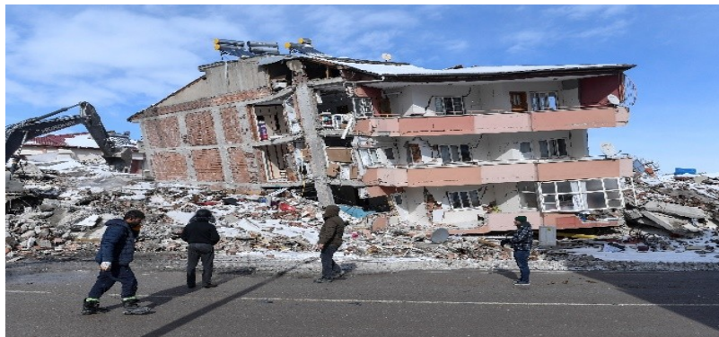
Εικόνα 2 Η παραμόρφωση ενός κτηρίου που δέχτηκε σεισμό [7]
