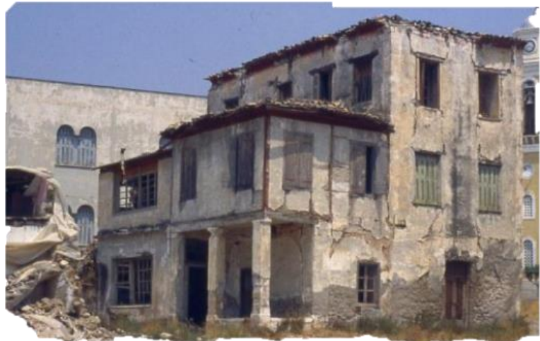
Εικόνα 5.10: Στο κτήριο αυτό όπου παρέμεινε το ξύλινο δάπεδο έχει δεχθεί επισκευάσιμες ζημιές χωρίς κατάρρευση.
