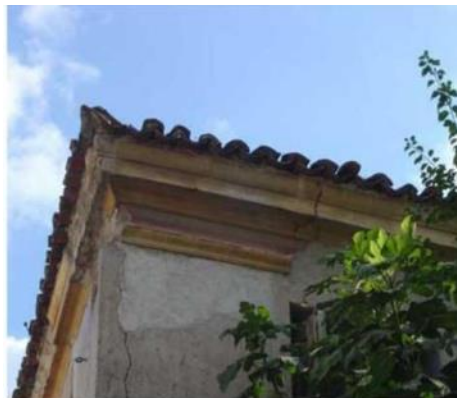
Εικόνα 2.12: Προβλήματα στην στέγη λόγω υγρασίας.
