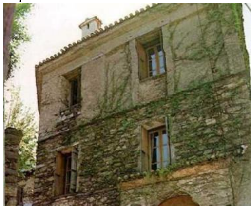
Εικόνα 2.14: Βλάστηση στην τοιχοδομή.
