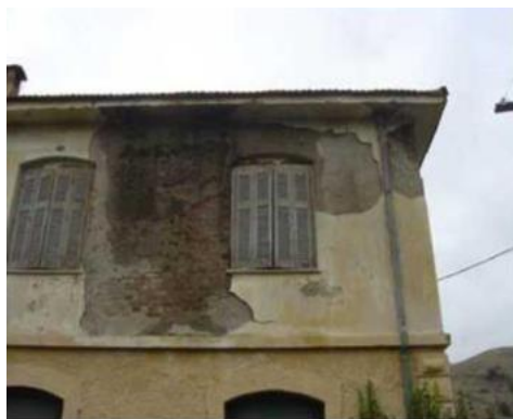
Εικόνα 2.10: Διάβρωση του τοίχου
