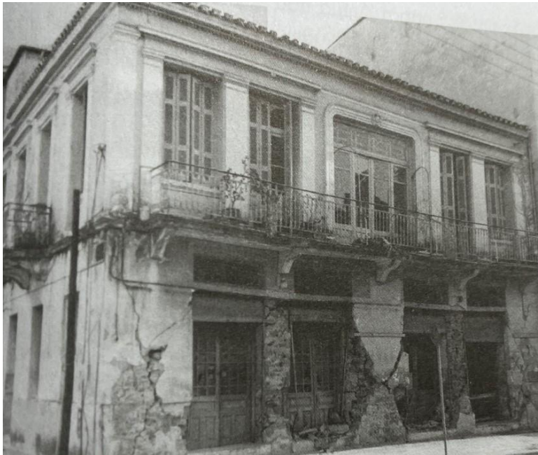
Εικόνα 2.5 Βλάβες στο ισόγειο ενός νεοκλασικού κτηρίου.
