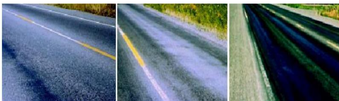
Εικόνα 23 : Επίπεδα σοβαρότητας του φαινομένου εξίδρωσης της ασφάλτου.
