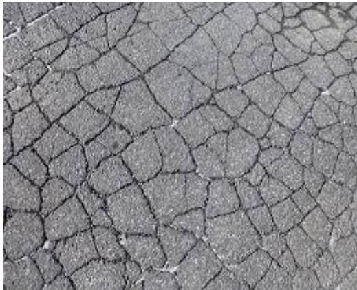
Εικόνα 13 : Ρωγμές τύπου αλιγάτορα.
