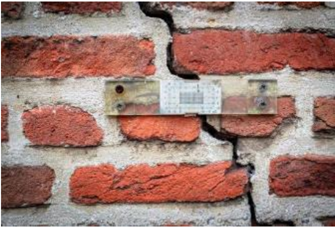
Εικόνα 56 πλαστικό μηχανικό μετρητή ρωγμών (crack meter)
