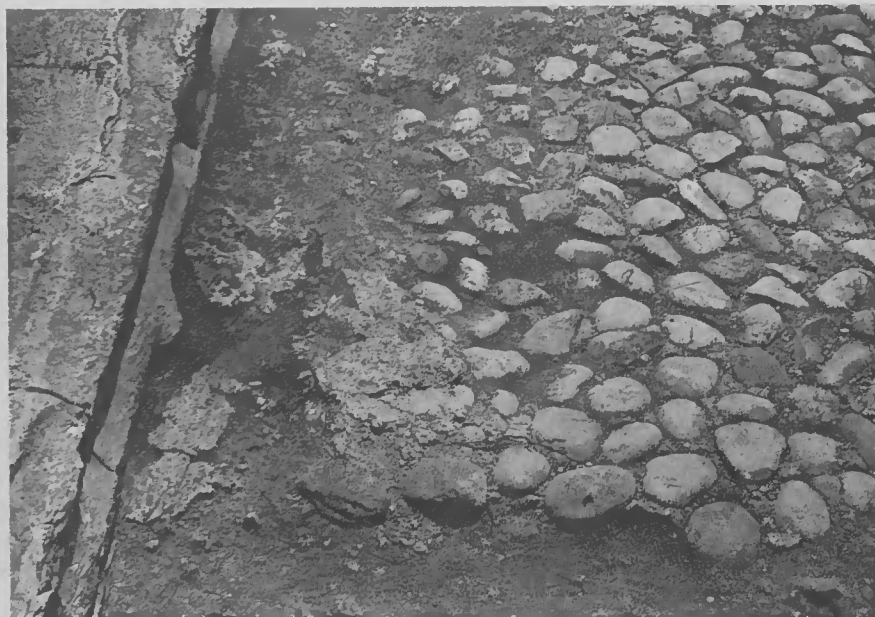
Abb. 45. Peristasiboden. Mörtelbelag teilweise fehlend. — 1926.
