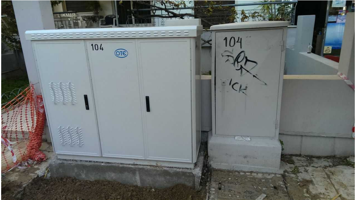
Εικόνα 3.13 - Οπτικό KV – Παλαιού τύπου KV
