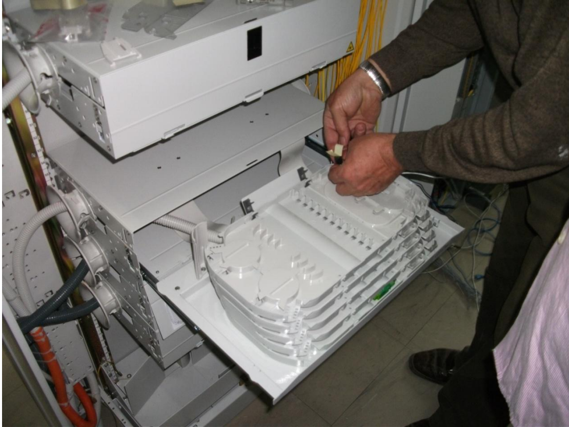
Εικόνα 25: Οργανωτρες μεσα στα πλαισια οπτικων κατανεμητων
