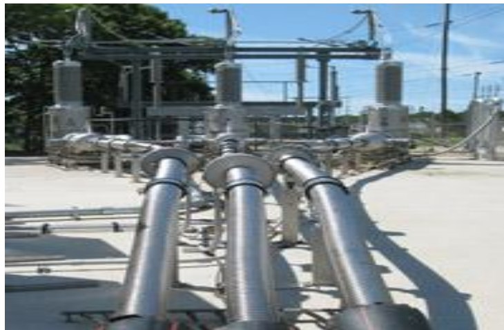
Υπεραγωγοί και μονάδα ψύξης .
