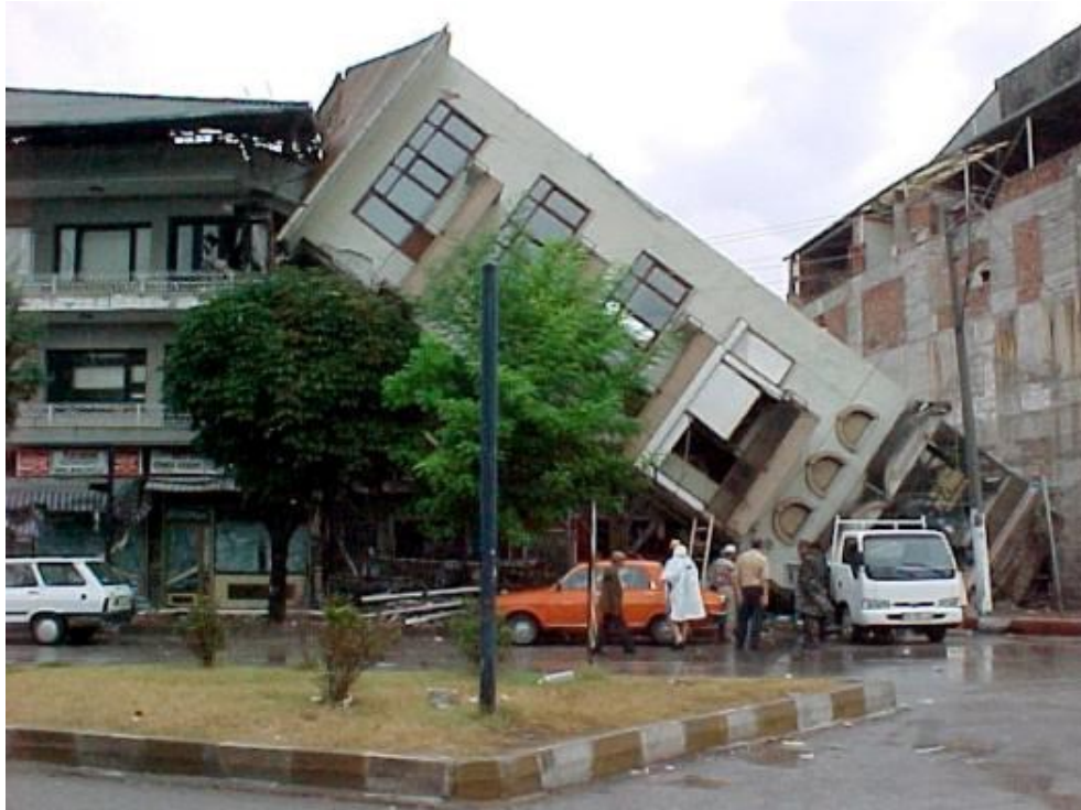
Εικόνα 1.3 Αστοχία θεμελίωσης λόγω ρευστοποίησης [11].
