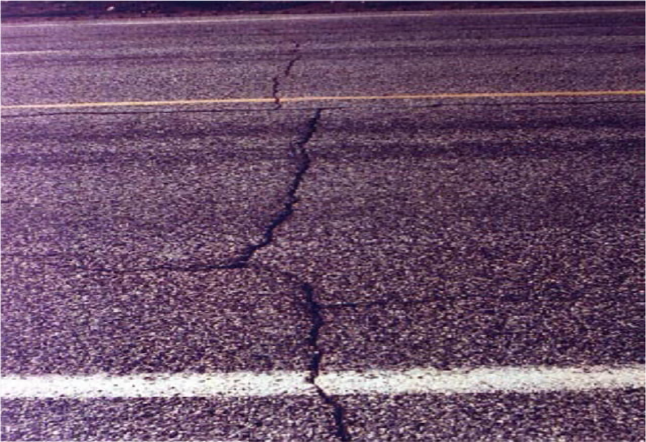
Εικόνα 2.6 Εγκάρσια ρωγμή (διαδίκτυο)
