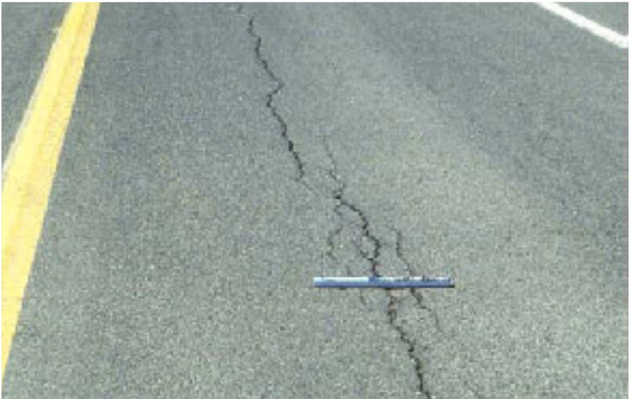
Εικόνα 2.7 Διαμήκειες ρωγμές (διαδίκτυο)
