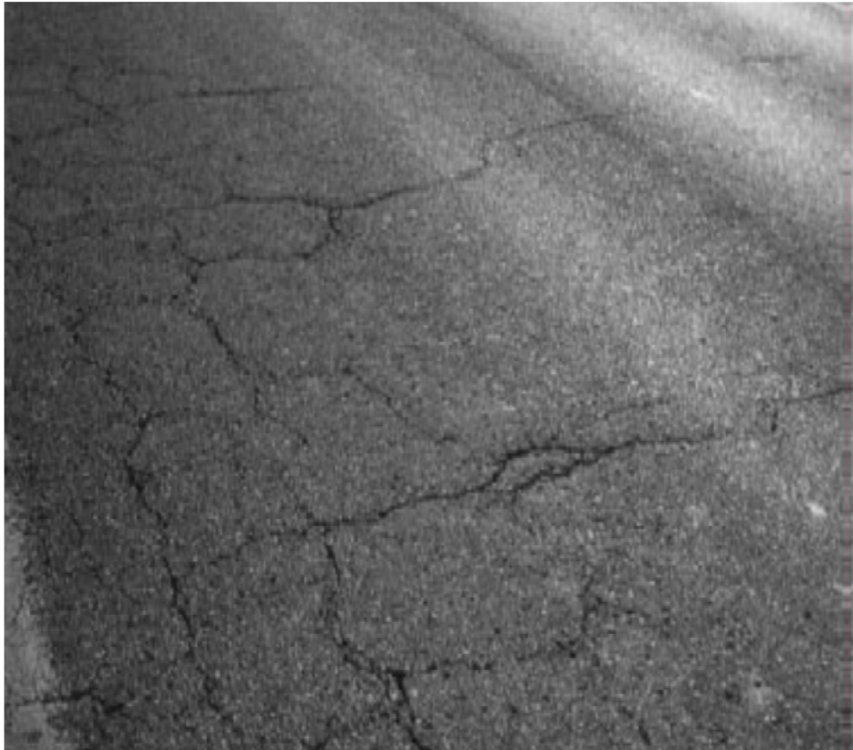
Εικόνα 2.8 Ρωγμή συστολής η συρρίκνωσης (διαδίκτυο)
