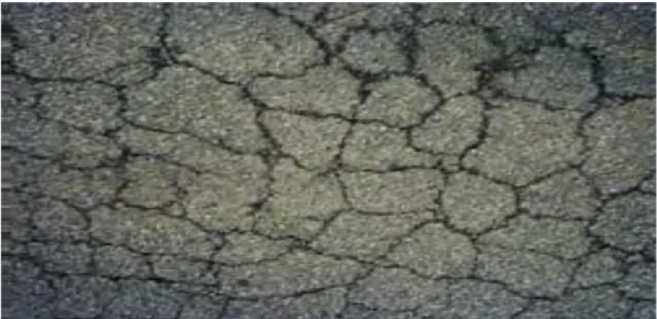
Εικόνα 2.1 Ρωγμές τύπου αλιγάτορα σε οδόστρωμα (διαδίκτυο)
