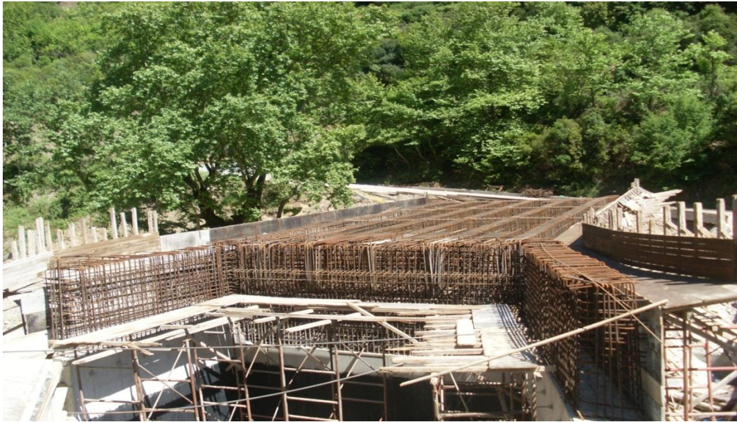
ΦΩΤΟΓΡΑΦΙΑ 6.9 ΑΠΟΨΗ ΤΟΥ ΚΑΤΑΣΤΡΩΜΑΤΟΣ ΚΑΙ ΤΟΥ ΔΥΤΙΚΟΥ ΑΚΡΟΒΑΘΡΟΥ ΜΕΤΑ ΤΗΝ ΤΟΠΟΘΕΤΗΣΗ ΤΟΥ ΑΠΑΙΤΟΥΜΕΝΟΥ ΟΠΛΙΣΜΟΥ.
