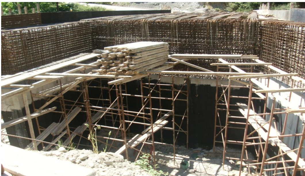
ΦΩΤΟΓΡΑΦΙΑ 6.14 ΤΟ ΑΝΑΤΟΛΙΚΟ ΑΚΡΟΒΑΘΡΟ ΚΑΤΑ ΤΗ ΦΑΣΗ ΚΑΤΑΣΚΕΥΗΣ ΤΗΣ ΚΕΦΑΛΗΣ ΤΟΥ ΚΑΤΑΣΤΡΩΜΑΤΟΣ ΜΕ ΤΟ ΟΠΟΙΟ ΣΥΝΔΕΕΤΑΙ ΜΟΝΟΛΙΘΙΚΑ.
