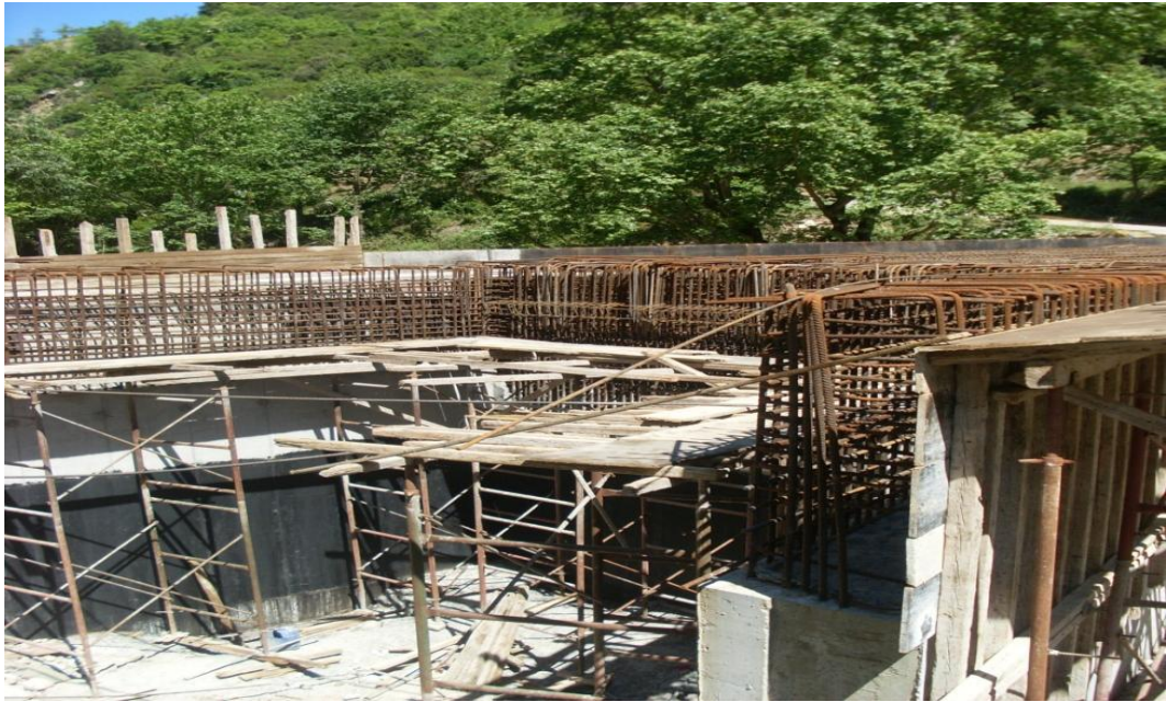
ΦΩΤΟΓΡΑΦΙΑ 6.13 ΛΕΠΤΟΜΕΡΕΙΑ ΤΗΣ ΚΕΦΑΛΗΣ ΤΟΥ ΔΥΤΙΚΟΥ ΑΚΡΟΒΑΘΡΟΥ ΠΡΙΝ ΤΗ ΣΚΥΡΟΔΕΤΗΣΗ ΤΟΥ ΚΑΤΑΣΤΡΩΜΑΤΟΣ.
