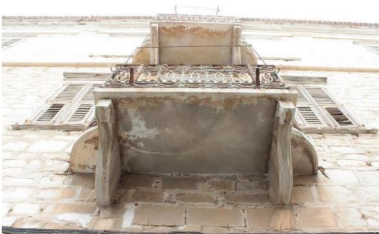
Εικόνα 142: Το μπαλκόνι του ισογείου στην νότια όψη. Διακρίνεται η ρωγμή στο αριστερό τμήμα του.
