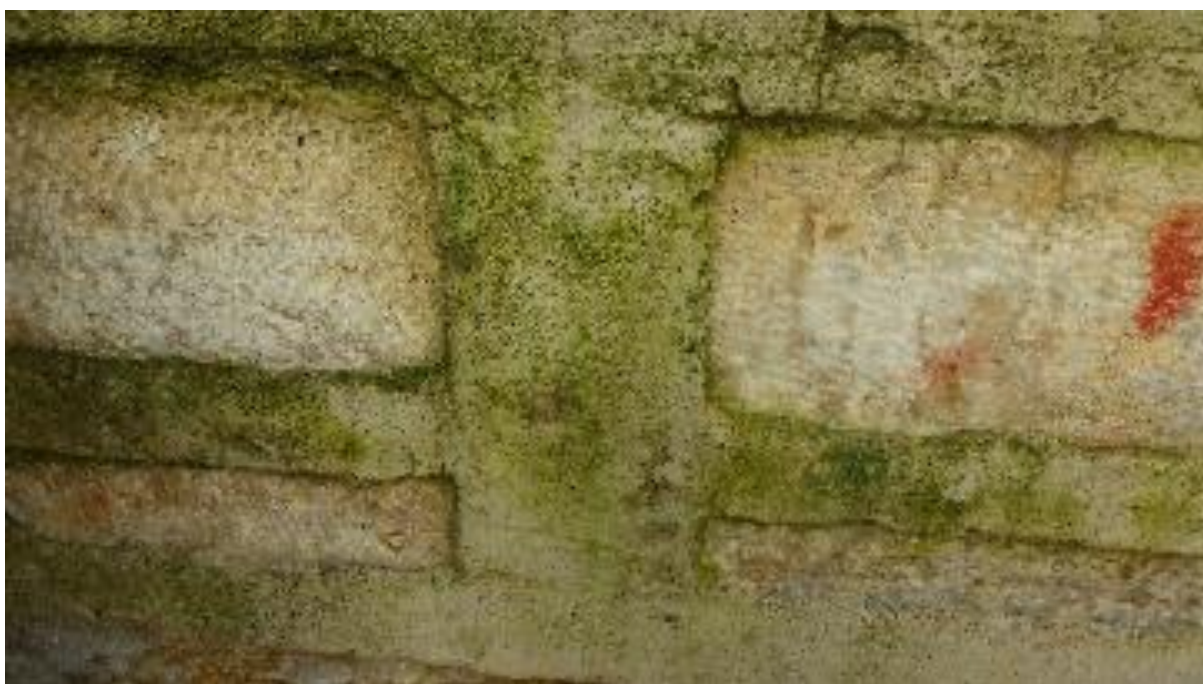
Εικόνα 121: Μεταγενέστερες επεμβάσεις αντικατάστασης του κονιάματος της εξωτερικής τοιχοποιίας με τσιμεντοκονίαμα.
