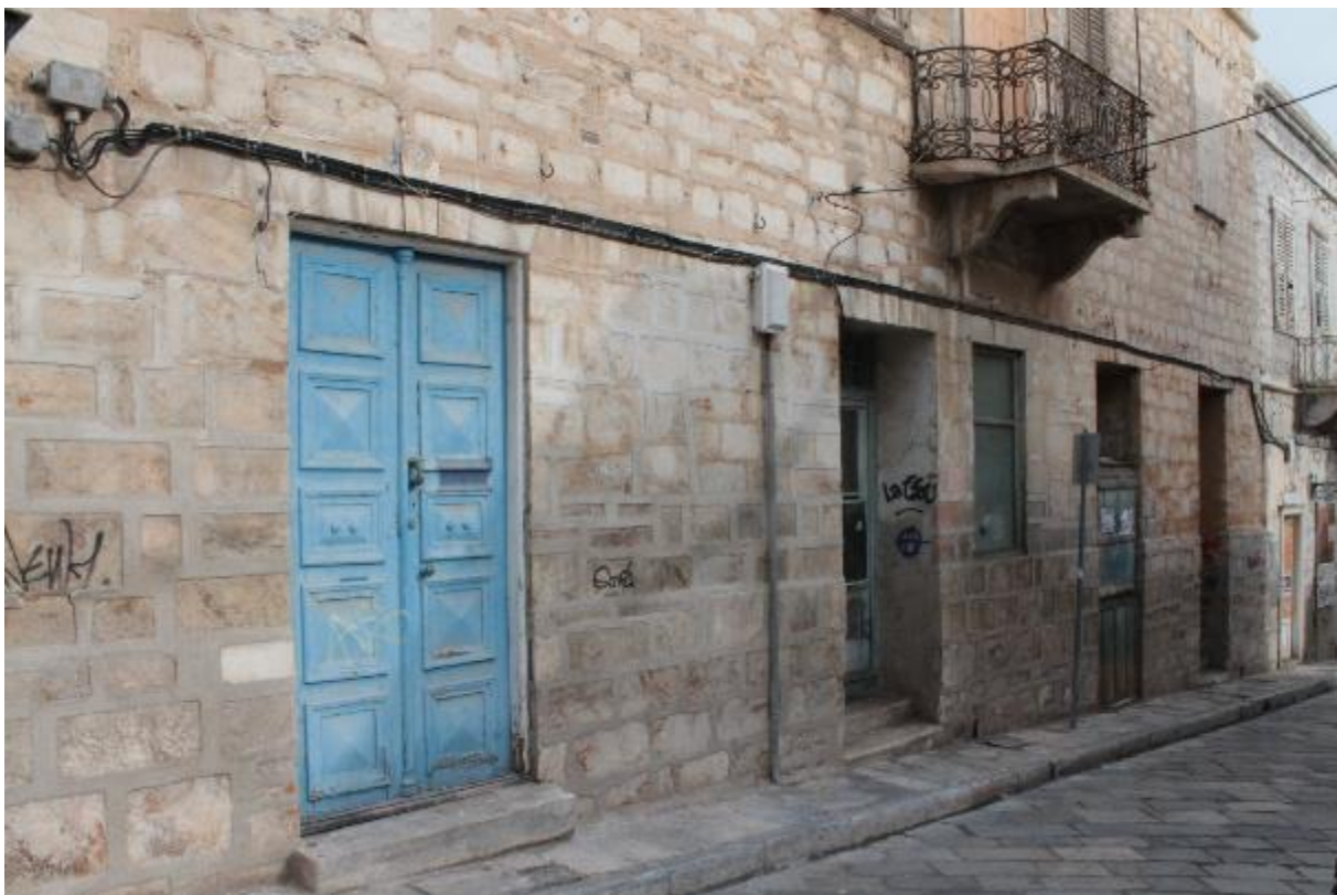
Εικόνα 37: Νότια όψη. Ασύμμετρα ανοίγματα στο υπόγειο σε σχέση με τους υπερκείμενους ορόφους.
