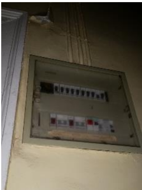
Εικόνα 111: Ο ηλεκτρικός πίνακας στον χώρο Α1 του ορόφου.
