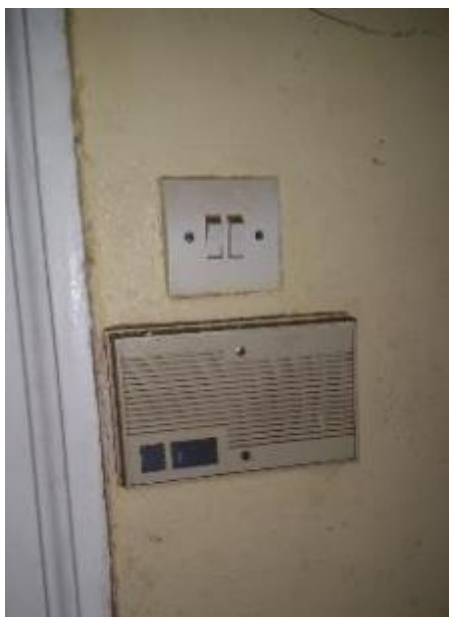
Εικόνα 113: Το θυροτηλέφωνο εισόδου στον χώρο Α1 του ορόφου.
