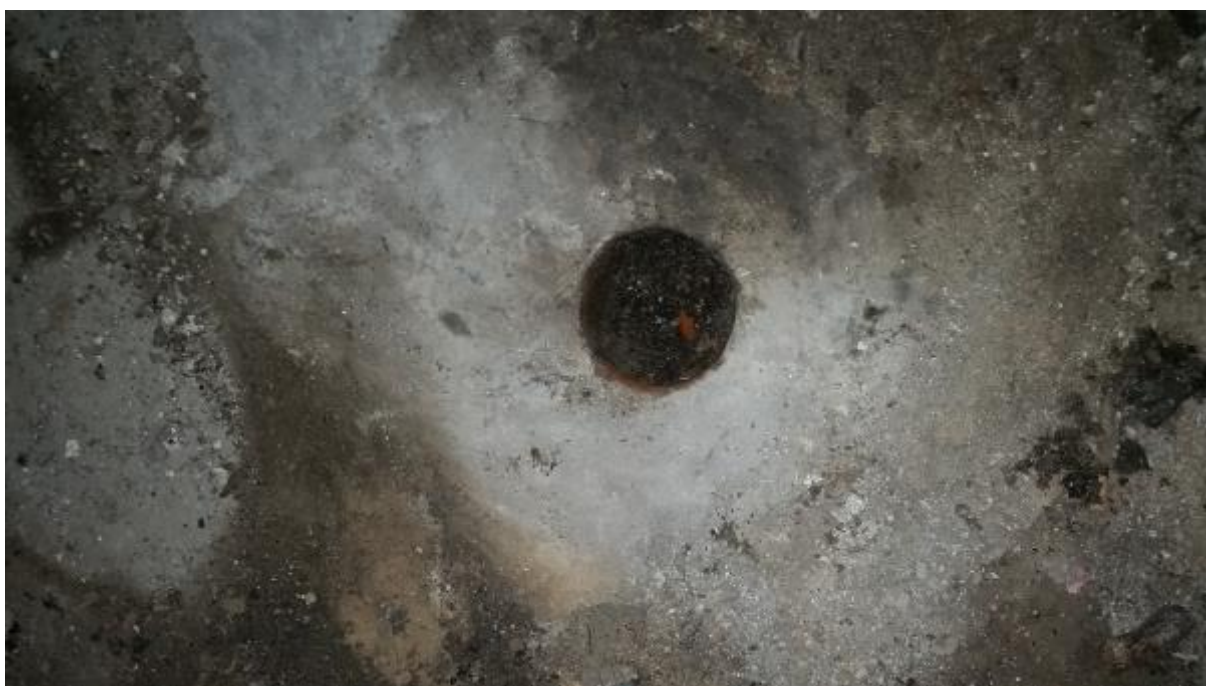
Εικόνα 50: Το στόμιο δαπέδου της δεξαμενής στο δάπεδο του υπόγειου χώρου Υ8.
