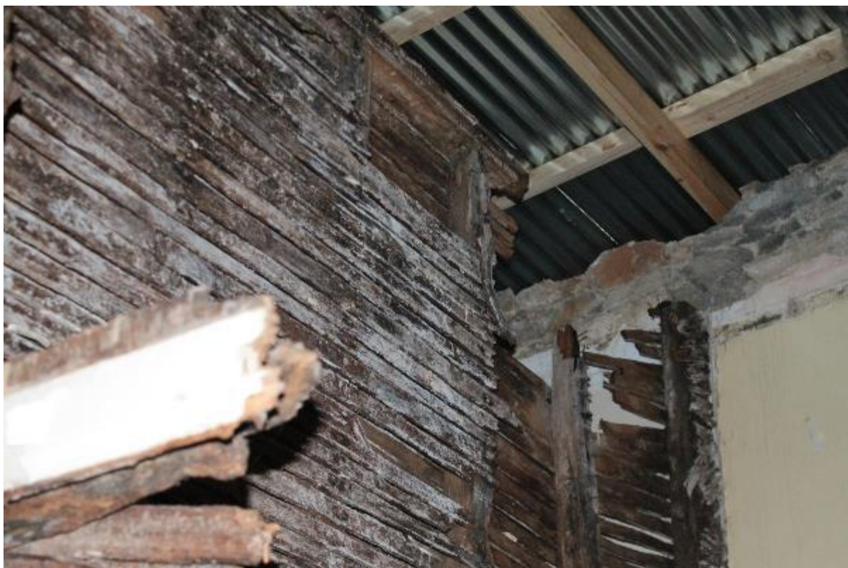
Εικόνα 127: Λεπτομέρεια εσωτερικής τοιχοποιίας. Διακρίνεται η προσβολή από την υγρασία σε όλα τα τμήματα που την αποτελούν.
