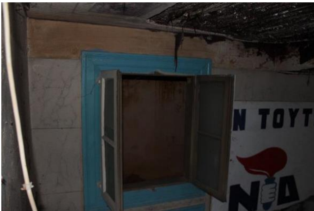
Εικόνα 135: Αποκόλληση τμημάτων της οροφολογίας στο κλιμακοστάσιο της νότιας εισόδου.
