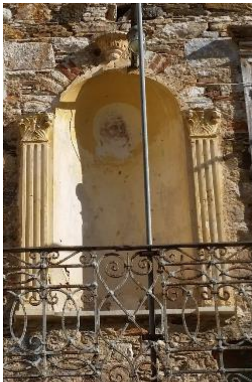
Εικόνα 106: Ο ζωγραφιστός θόλος στον δυτικό τοίχο στο επίπεδο του ορόφου. Η γύψινη κατασκευή είναι σχεδόν κατεστραμμένη.
