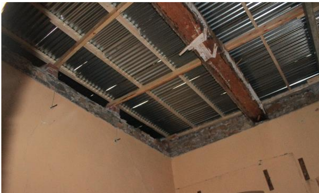
Εικόνα 130: Η οροφή του ορόφου στον χώρο Α9. Παρατηρείται ολική κατάρρευση του δώματος και η επιφάνεια έχει επικαλυφθεί με μεταλλικό αυτοφερόμενο στοιχείο.
