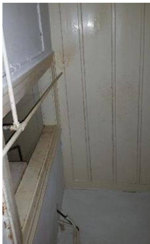
Εικόνα 115: Η θέση του ηλεκτρικού θερμοσίφωνα πάνω από τον χώρο Α3 και με πρόσβαση από τον χώρο Α4.
