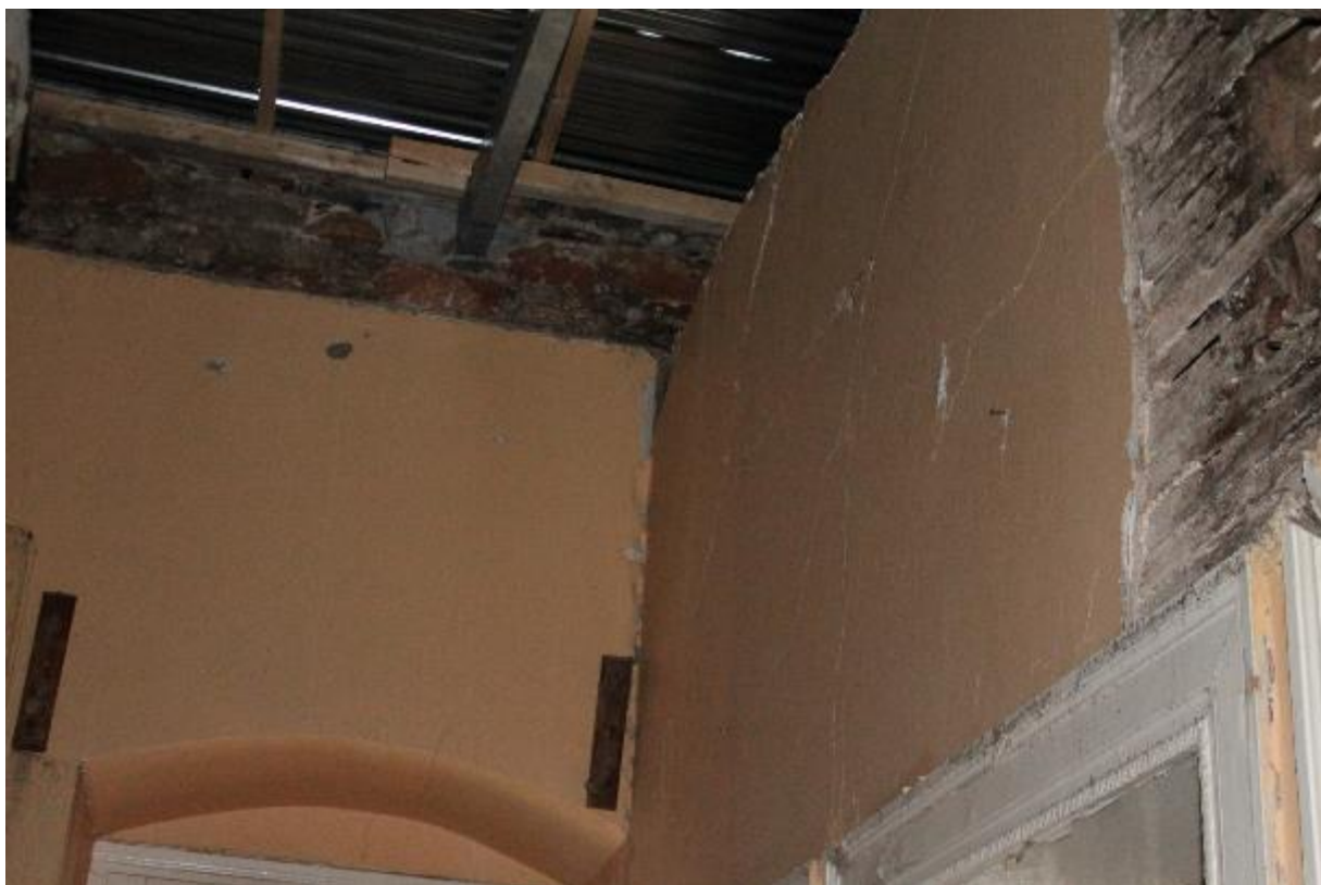
Εικόνα 129: Επιχρίσματα τοιχοποιίας Α' ορόφου. Παρατηρείται αποσταθεροποίηση από την τοιχοποιία.
