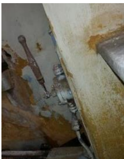
Εικόνα 110: Η μηχανική αντλία υδροδότησης στην κουζίνα του ισόγειου, χώρος 18.
