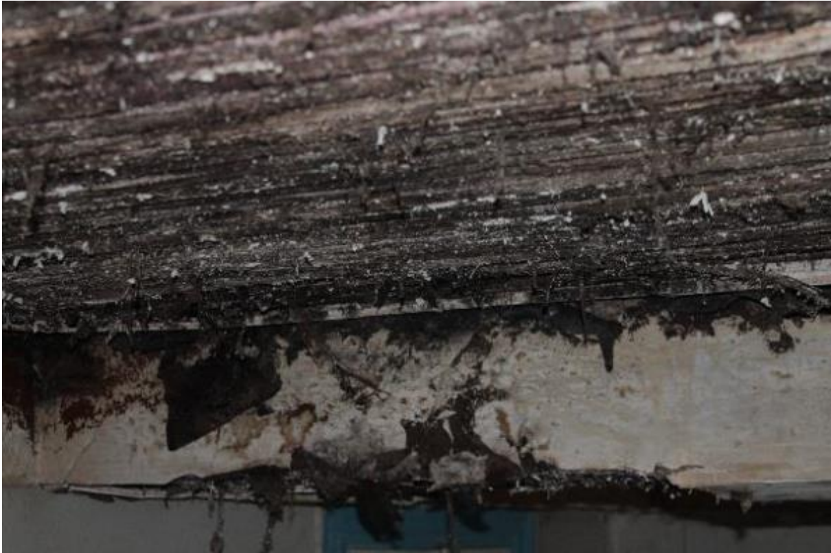
Εικόνα 144: Λεπτομέρεια οροφής νότιας εισόδου στον χώρο Υ8. Η βλάβη είναι εκτεταμένη.
