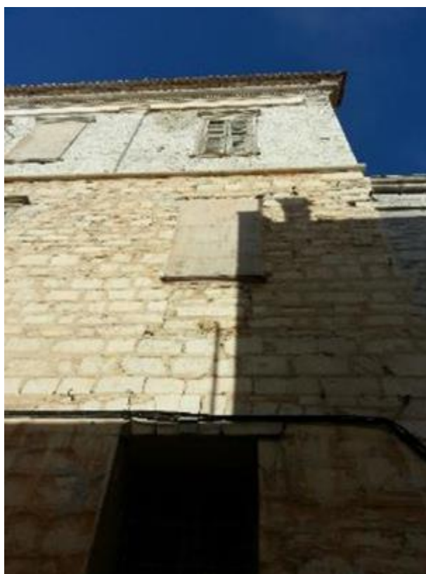
Εικόνα 67: Ο σοβατισμένος όροφος με πεταχτό κονίαμα.
