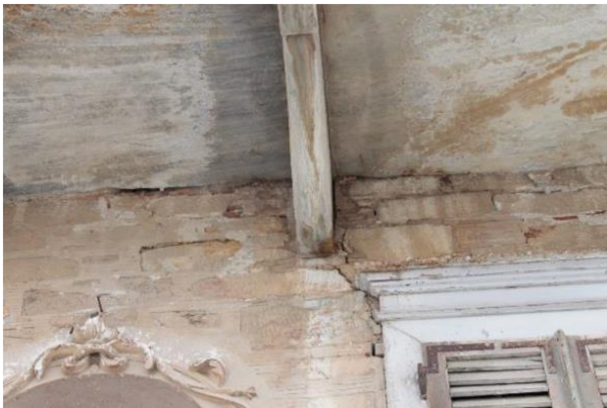
Εικόνα 119: Ρηγματώσεις της τοιχοποιίας στον δυτικό τοίχο.
