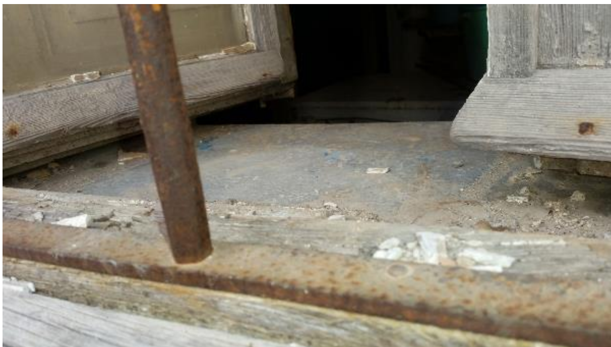
Εικόνα 143: Λεπτομέρεια σιδεριάς σε παράθυρο της βόρειας όψης. Η οξείδωση είναι εμφανής.
