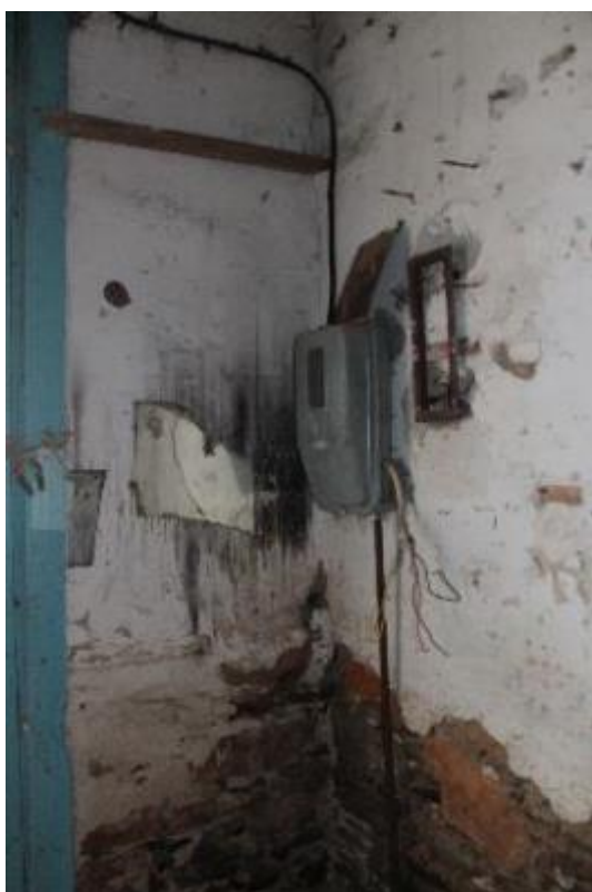
Εικόνα 147: Καταμετρητής της ΔΕΗ στον χώρο Υ2. Διακρίνονται κομμένα καλώδια χωρίς προστασία.
