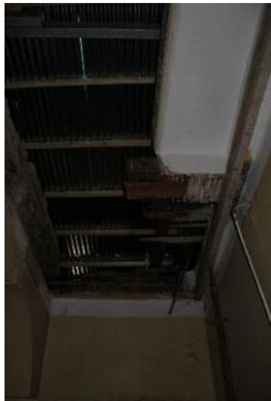
Εικόνα 124: Κατάρρευση του δώματος.
