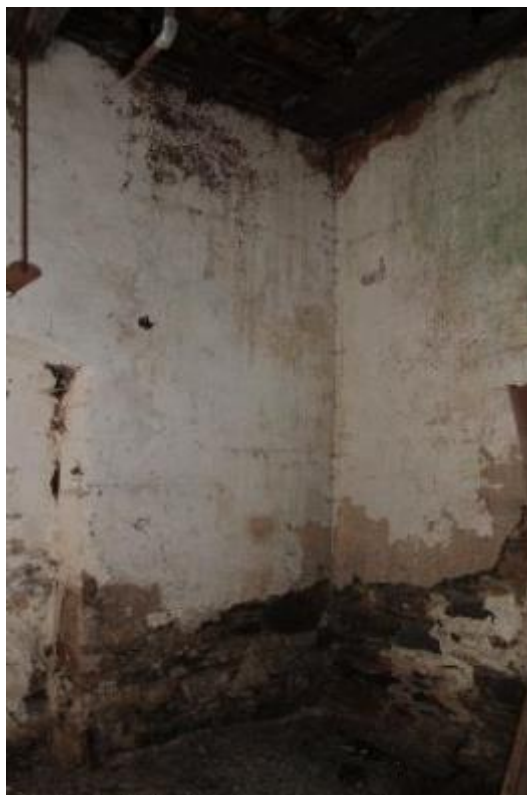
Εικόνα 117: Αποκόλληση των επιχρισμάτων και συγκέντρωση μικροοργανισμών (μούχλας) στον χώρο του υπογείου.
