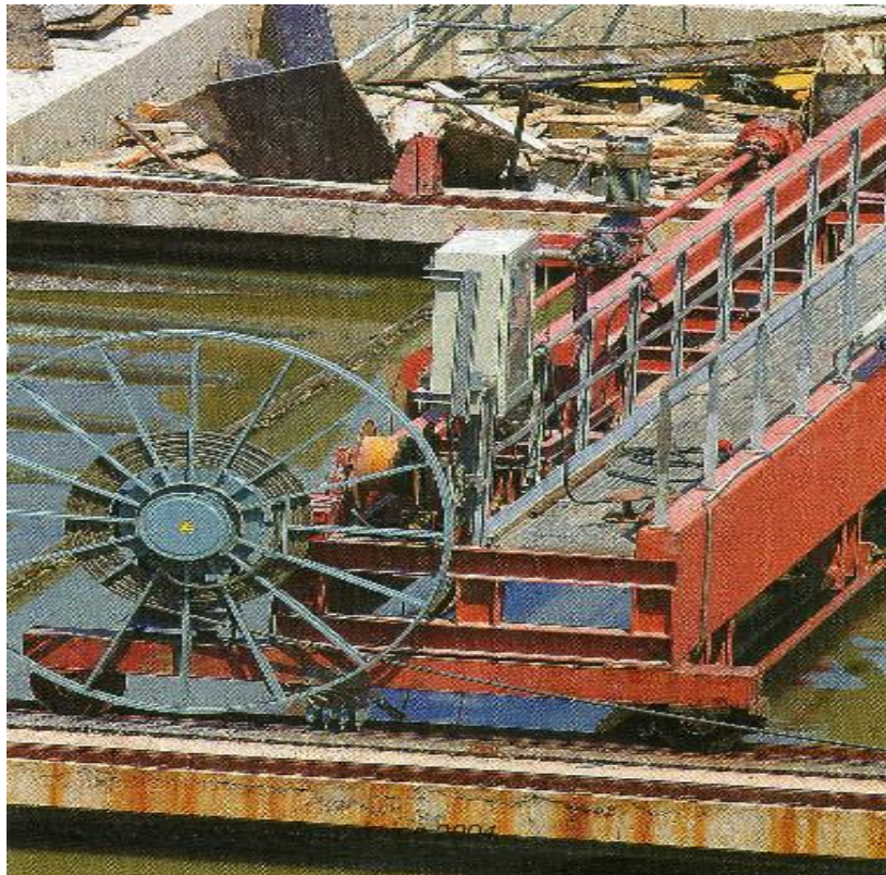
Εικόνα 11 Δεξαμενή πρωτοβάθμιας καθιζήσεως
