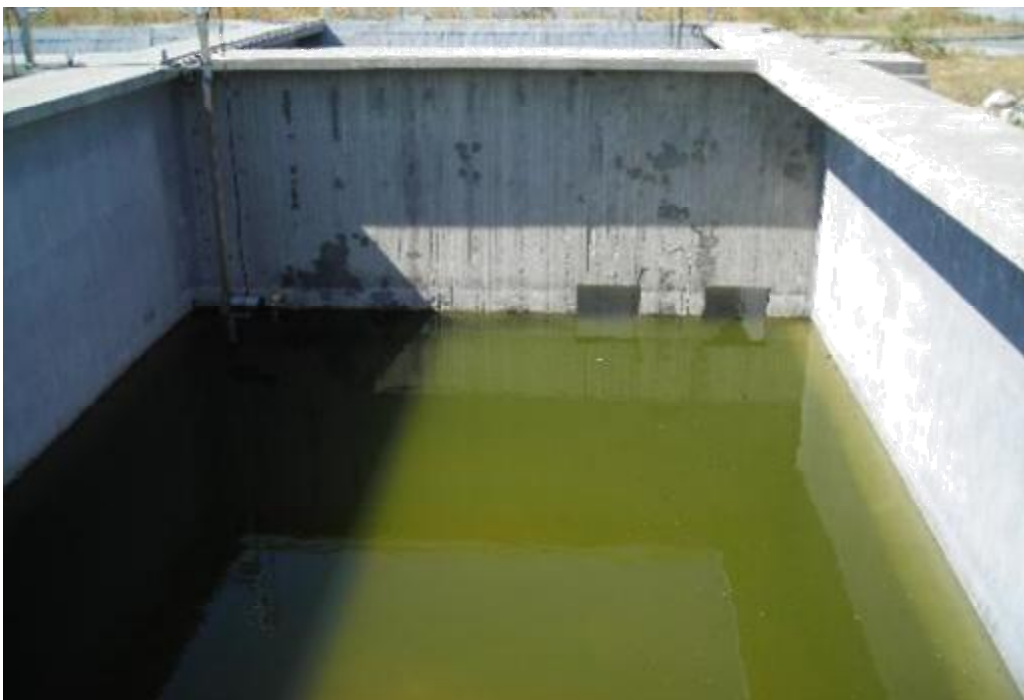
Εικόνα 15: Αναερόβια δεξαμενή φωσφόρου
