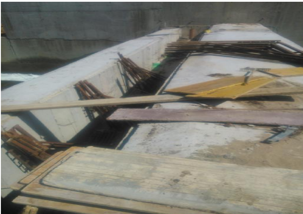
Εικόνα 50. Τοίχος ρουφράχτη για την συλλογή υδάτων και προσπέλαση στο θυρόφραγμα.
