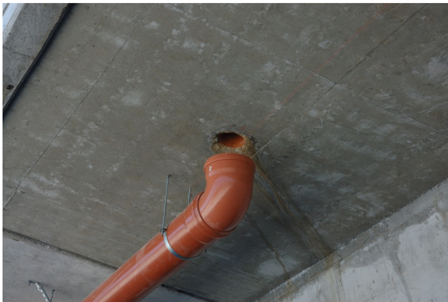
Φωτ. 6.25: Αγωγός παροχέτευσης ομβρίων υδάτων.
