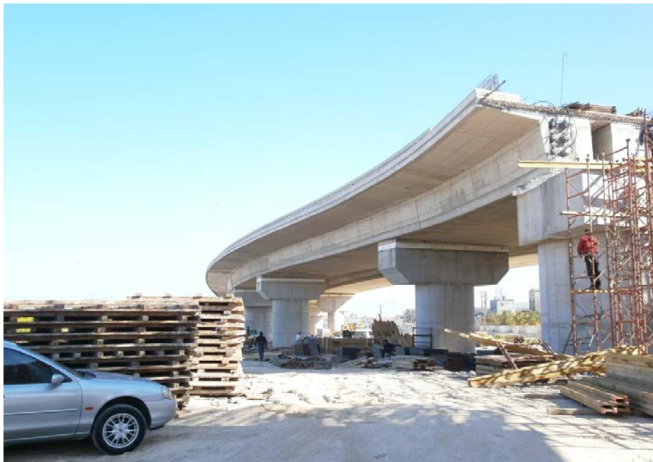
Φωτ. 6.9: Νοτιοδυτική όψη ολόκληρης της γέφυρας T2. Διακρίνεται σε πρώτο πλάνο το μεσόβαθρο M8.Δ και ακολουθούν σε δεύτερο πλάνο τα μεσόβαθρα M7.Δ και M6.Δ.
