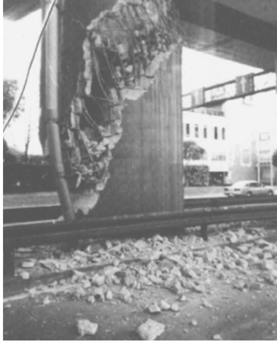
Σχήμα 2.3 - Διατμητική αστοχία βάρου γέφυρας στο σεισμό του Kobe, Ιαπωνία, το 1995.
