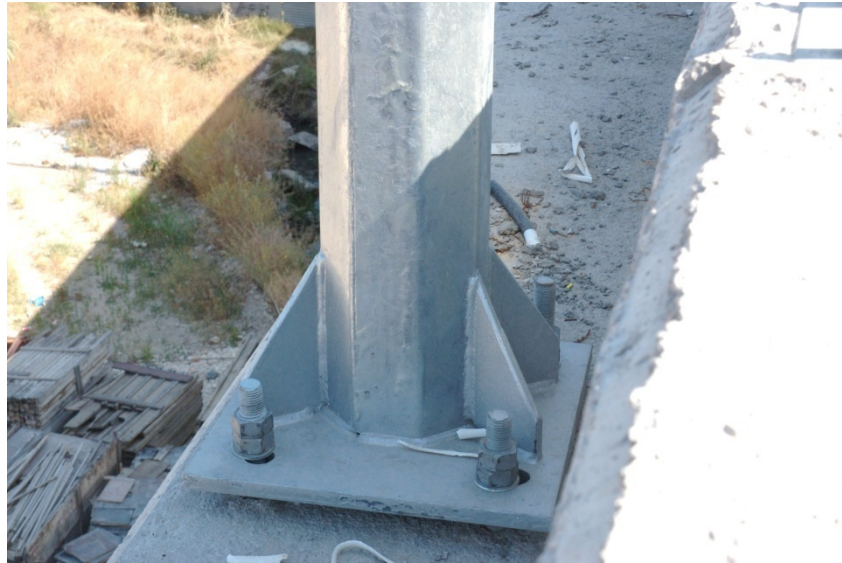
Φωτ. 6.24: Βάση της λάμπας ηλεκτροφωτισμού.
