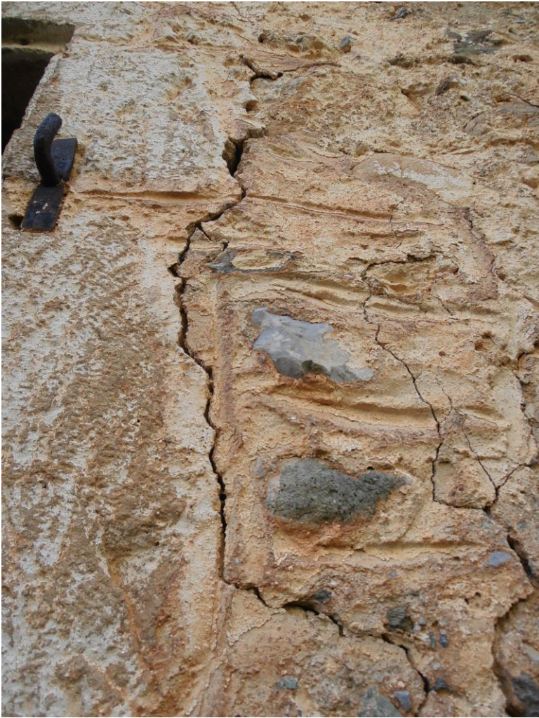
Εικόνα 6 Φθορές στην τοιχοποιία
