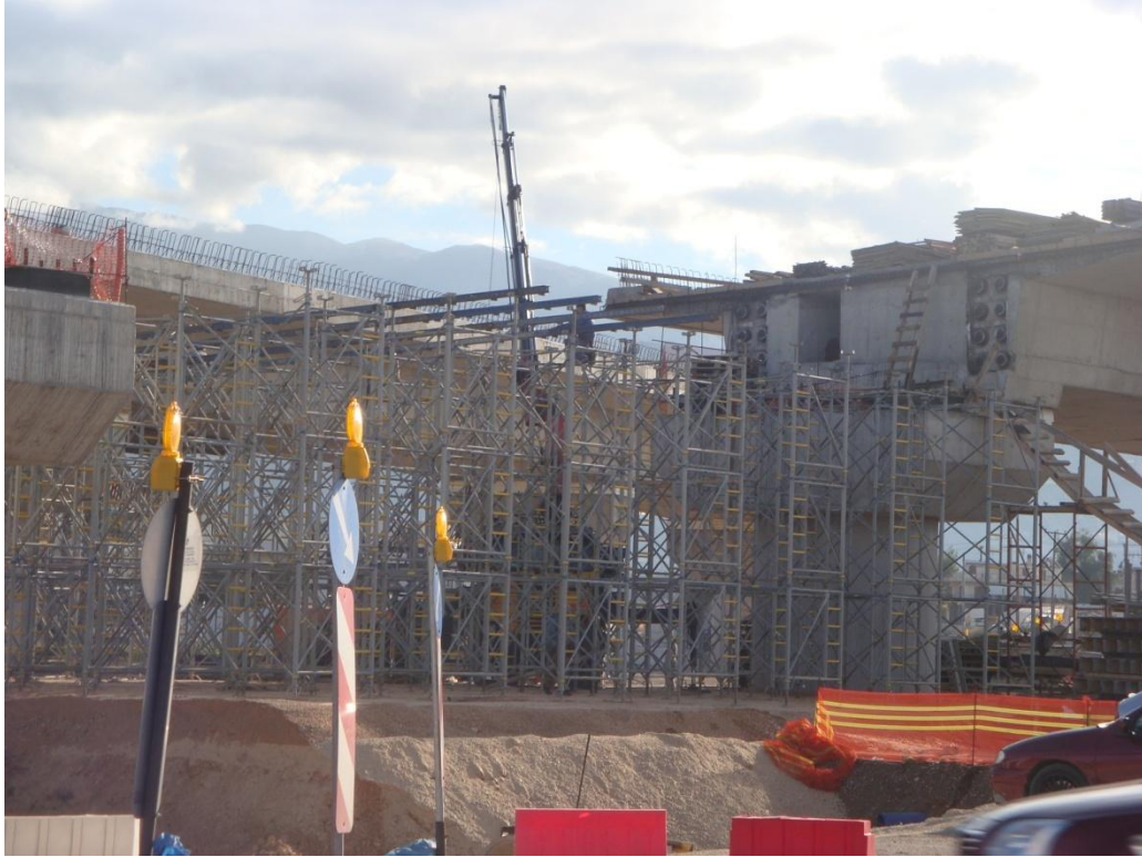
Φωτ.7.4 Βορειοανατολική όψη του μεσοβάθρου M12.Δ της παρούσας γέφυρας κατά την κατασκευή των ικριωμάτων επί των οποίων σκυροδετήθηκε η ανωδομή.
