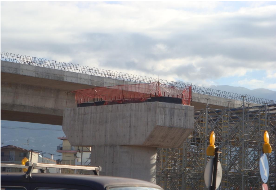
Φωτ.7.5 Το μεσόβαθρο M11.Δ της παρούσας γέφυρας ολοκληρωμένο με τα εφέδρανα τοποθετημένα στις θέσεις τους.
