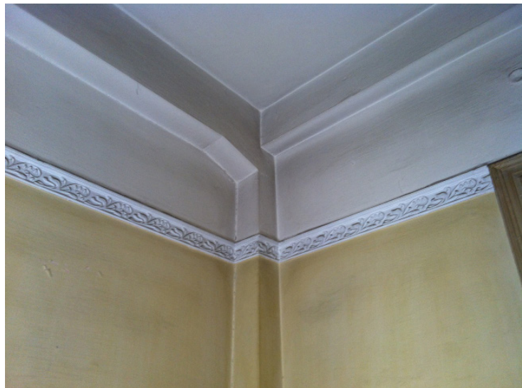
εικ. 84 Κατασκευαστική Λεπτομέρεια, μπετόν αρμέ και διακοσμητική ταινία στο ύψος του πρεκιού
