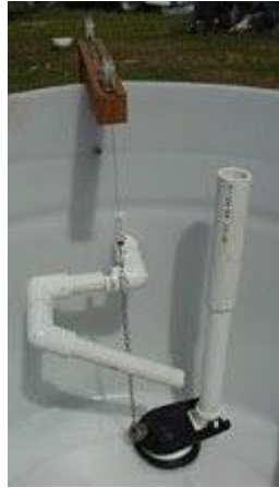
Εικόνα 23. Σωληνώσεις (Πηγή: www.fastonline.org )
