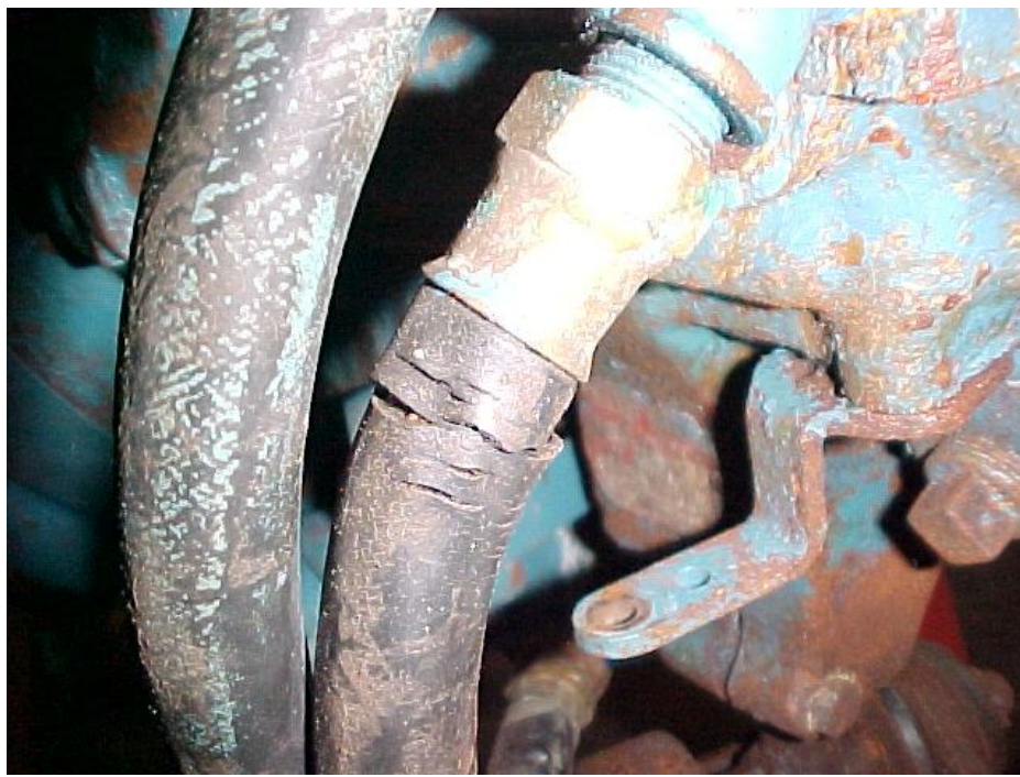
Σχήμα 5.8: Φθαρμένες σωληνώσεις ροής λαδιού
