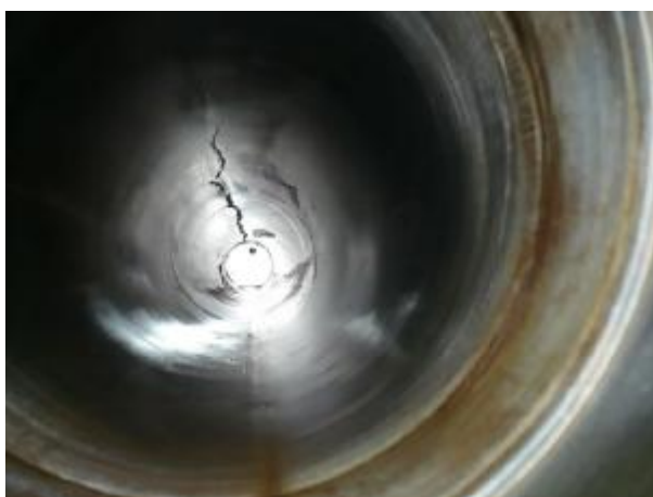
Σχήμα 5.2:Εσωτερική ρωγμή στον κύλινδρο
