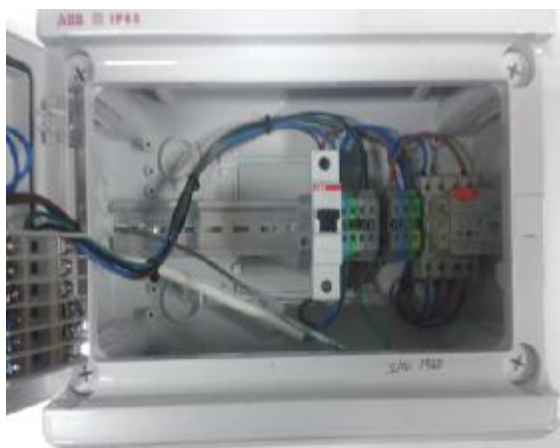
Εικόνα 4.27: Εσωτερικό ηλεκτρολογικού πίνακα.
