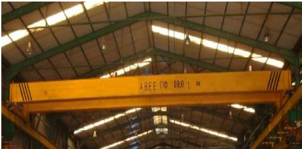
Εικόνα 5.1 :Γερανογέφυρα δυναμικότητας 10 τόνων τοποθετημένη σε βιομηχανικό κτίριο
