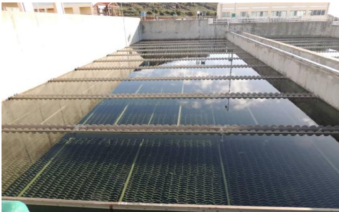
ΕΙΚΟΝΑ 10.11 : ΔΕΞΑΜΕΝΗ ΚΑΘΙΖΗΣΗΣ ΕΞΟΠΛΙΜΕΝΗ ΜΕ ΛΑΜΕΛΕΣ
