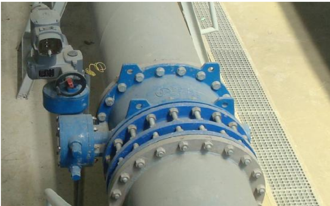
ΕΙΚΟΝΑ 9.2 : ΗΛΕΚΤΡΟΚΙΝΗΤΗ ΔΙΚΛΕΙΔΑ ΚΤΙΡΙΟΥ ΔΙΚΛΕΙΔΩΝ
