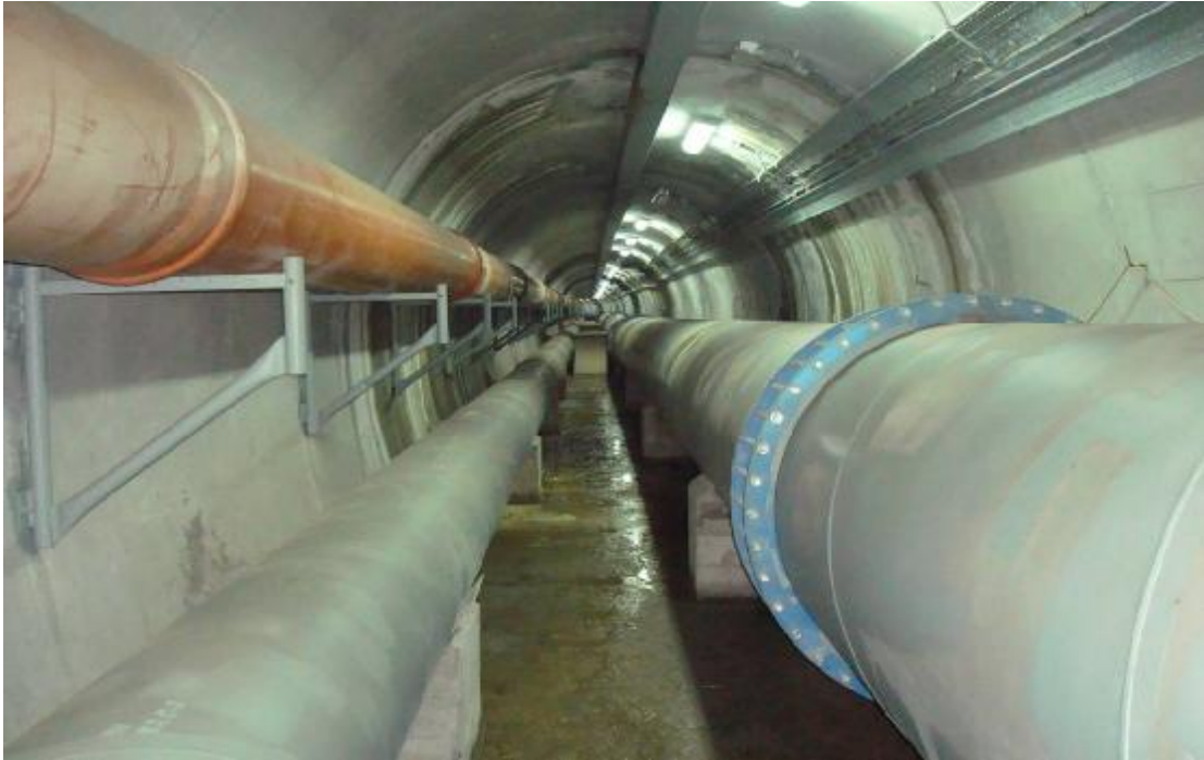
ΕΙΚΟΝΑ 9.1: ΧΑΛΥΒΔΙΝΟΙ ΑΓΩΓΟΙ ΕΝΤΟΣ ΤΗΣ ΣΗΡΑΓΓΑΣ, ΠΡΟΤΟΥ ΚΑΤΑΛΗΨΟΥΝ ΣΤΟ ΚΤΙΡΙΟ ΔΙΚΛΕΙΔΩΝ
