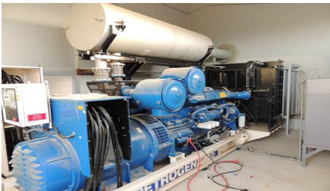
ΕΙΚΟΝΑ 10.22 : ΑΥΤΟΝΟΜΟ ΠΕΤΡΕΛΑΙΟΚΙΝΗΤΟ ΖΕΥΓΟΣ ΓΙΑ ΕΦΕΔΡΙΚΗ ΗΛΕΚΤΡΟΠΑΡΑΓΩΓΗ ΤΟΠΟΘΕΤΗΜΕΝΟ ΣΤΟ ΚΤΙΡΙΟ ΕΝΕΡΓΕΙΑΣ
