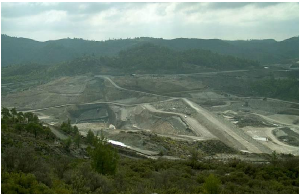
ΕΙΚΟΝΑ 3.1 : ΠΑΝΟΡΑΜΙΚΗ ΛΗΨΗ ΧΑΡΑΞΗ ΠΕΡΙΟΧΩΝ ΠΡΟΣ ΚΑΤΑΣΚΕΥΗ ΓΙΑ ΤΟ ΣΥΝΟΛΟ ΕΡΓΩΝ ΦΡΑΓΜΑΤΟΣ
