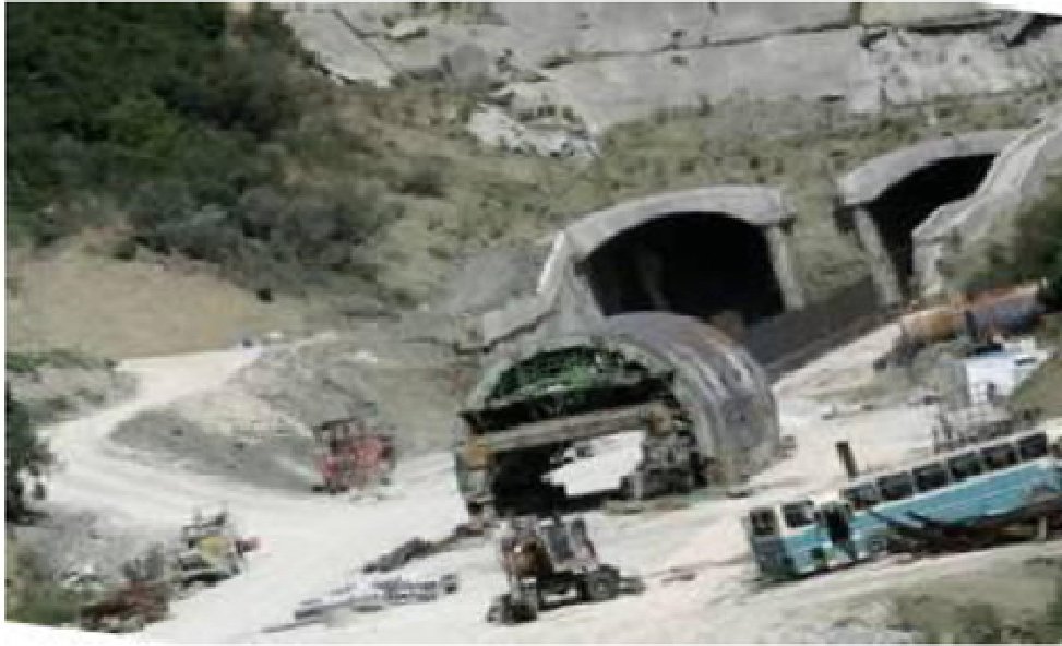
Εικόνα 15. Μέθοδος Cover & Cut. Διακρίνονται τα πλευρικά τοιχεία, η άνω πλάκα καθώς και το επίχωμα.
