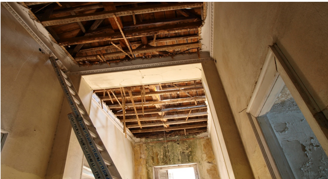
Εικόνα 35.Εμφάνιση του ζευκτού και των φθορών του στο διάδρομο του ορόφου
