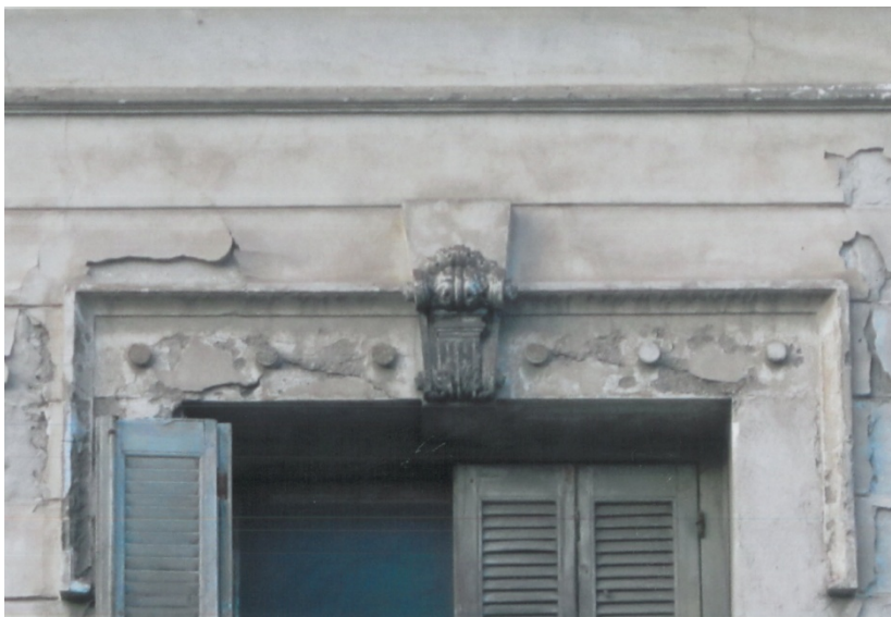
Εικόνα 19. Αποκολλήσεις στην εξωτερική τοιχοποιία
