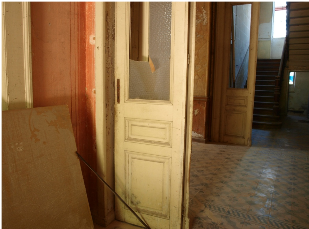
Εικόνα 17.Σπασμένα υαλοστάσια της πόρτας που οδηγεί στο κλιμακοστάσιο
