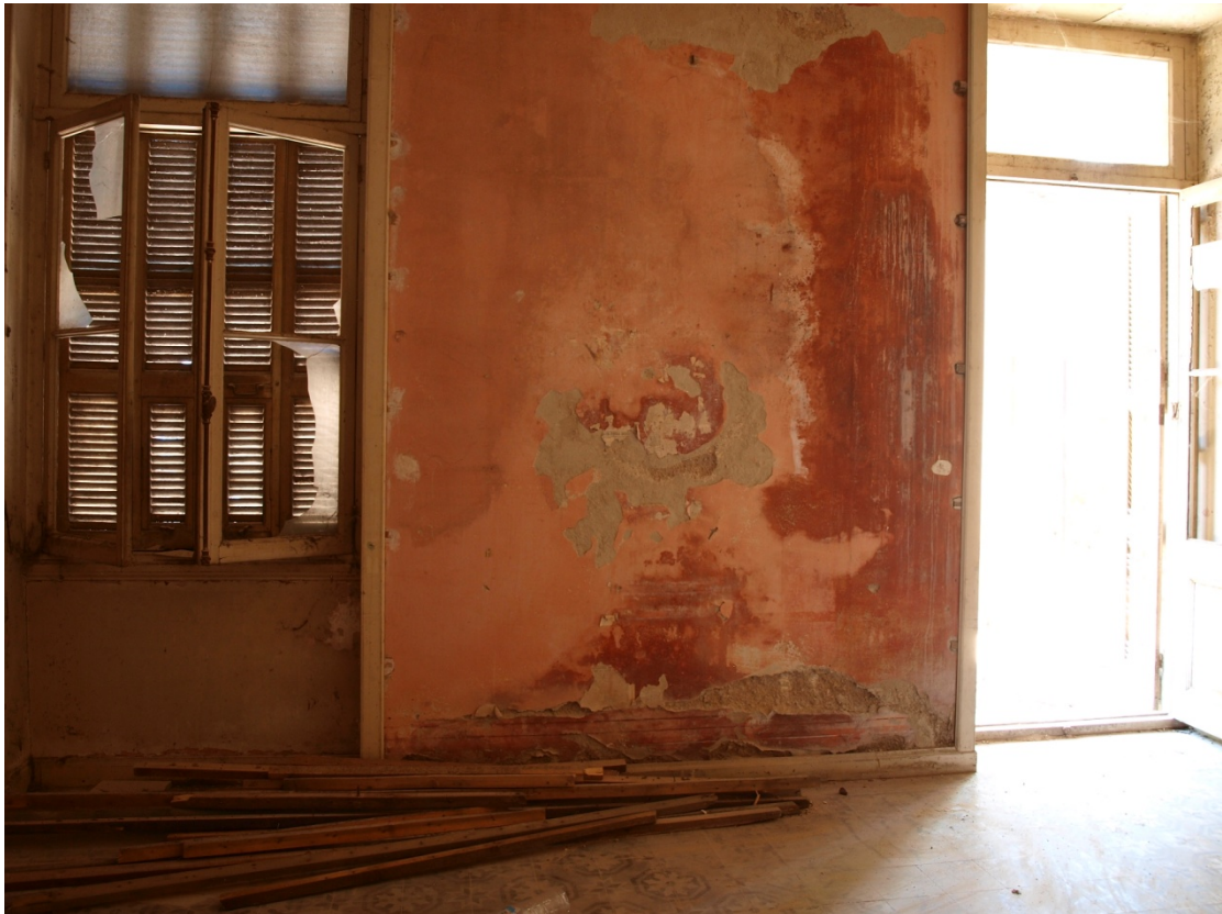
Εικόνα 15. Αποσάθρωση επιχρισματος από υγρασίες
