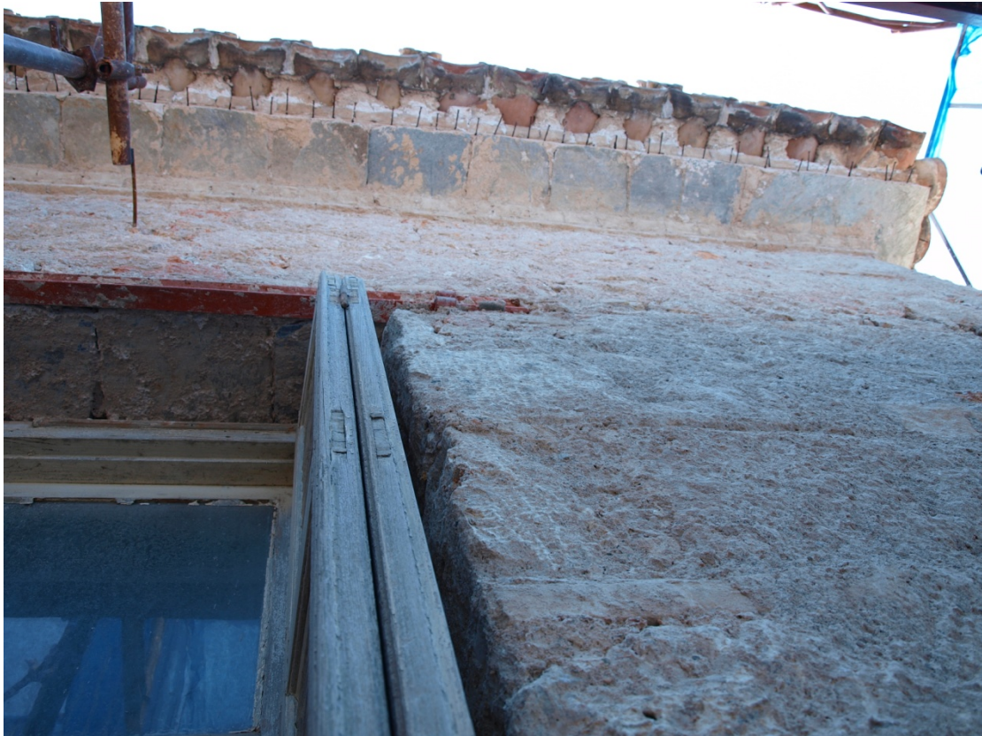
Εικόνα 22. Πτώση επιχρίσματος και ακροκέραμων
