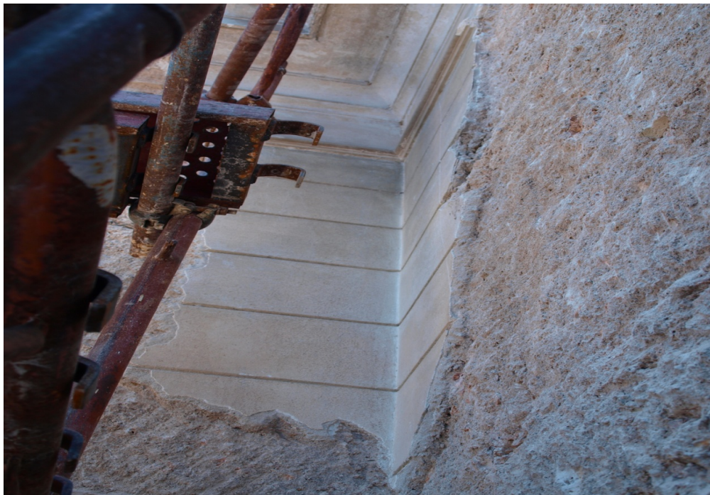
Εικόνα 14 Πτώση επιχρίσματος και εμφάνιση αργολιθοδομής
