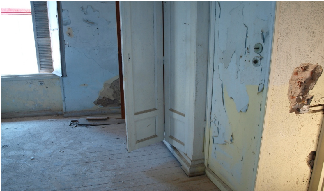
Εικόνα 32.Πτώση και αποκόλληση σαθρών υλικών σε δωμάτιο του ορόφου
