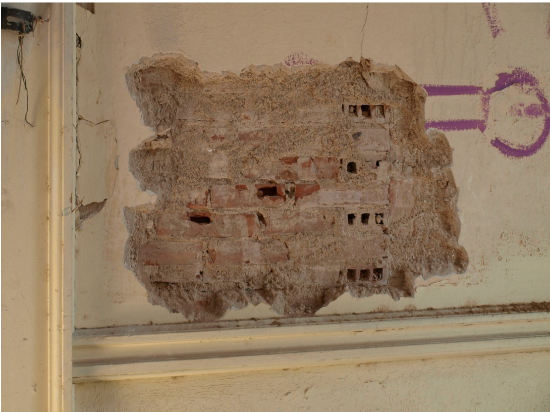
Εικόνα 30. Εμφάνιση οπτόπλινθων στον όροφο από πτώση σοβά
