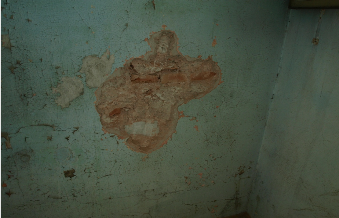
Εικόνα 29. Αποκολλήσεις επιχρισμάτων στον όροφο
