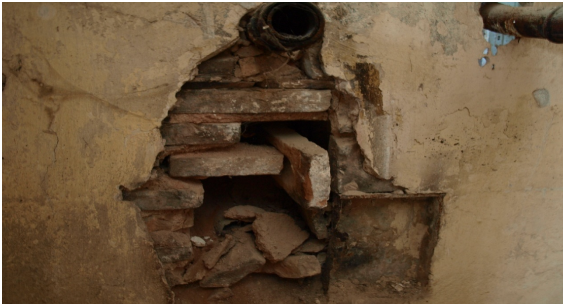
Εικόνα 28.Εμφάνιση σιδεροκατασκευής και οπτόπλινθων από αποκόλληση επιχρίσματος
