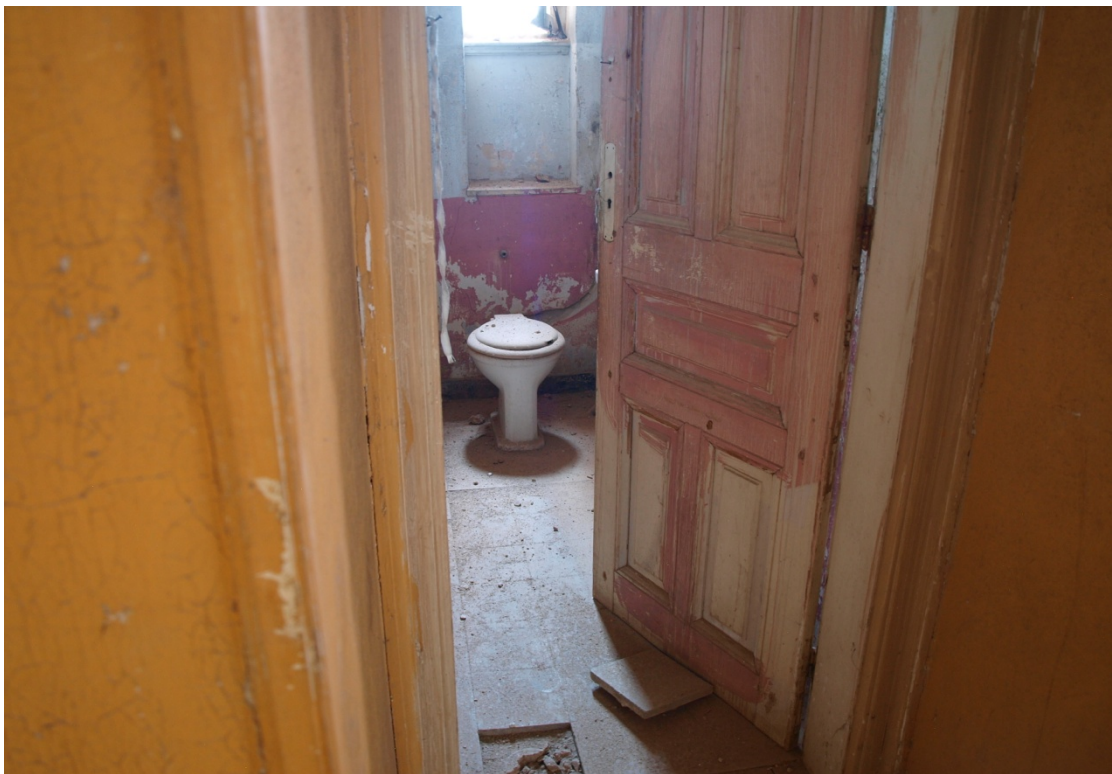
Εικόνα 52. Πόρτα w.c στον όροφο σε ροζ αποχρώσεις με εμφανείς φθορές
