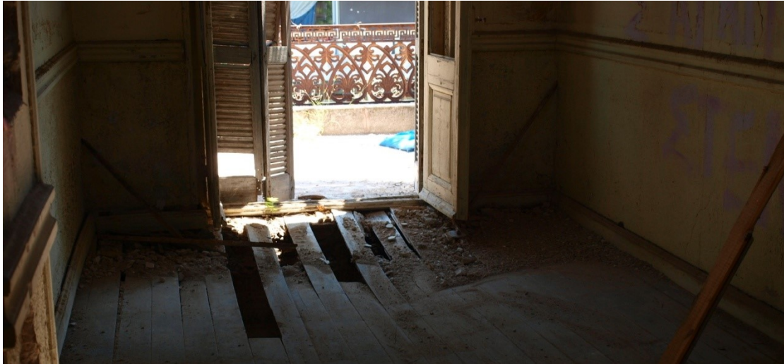
Εικόνα 39. Κατεστραμμένο τμήμα μεσοπατώματος
