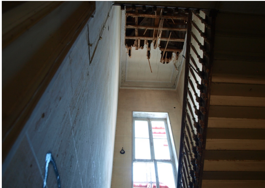
Εικόνα 43.Αποκόλληση της οροφής κλιμακοστασίου
