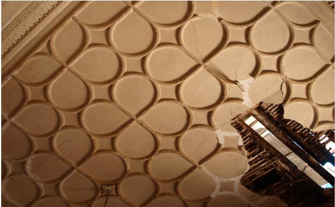
Εικόνα 40. Εμφάνιση μπαγδατί από την καταστροφή τμήματος του μεσοπατώματος και πτώση γύψινων διακοσμητικών
