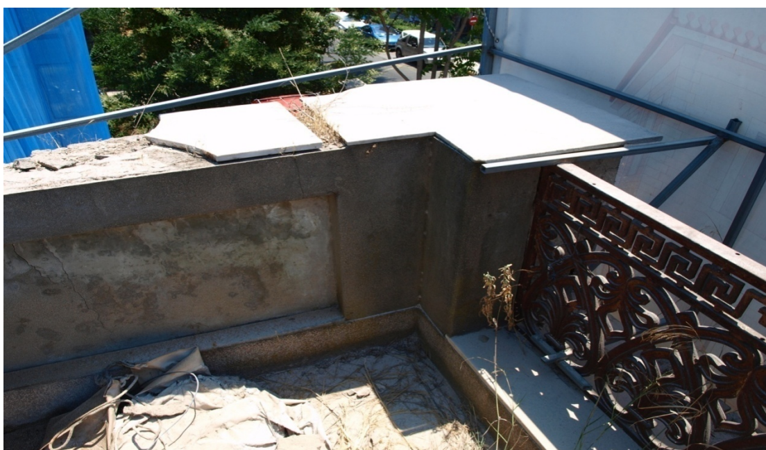
Εικόνα 58. Αποψη εξώστη, οξείδωση στα κάγκελα
