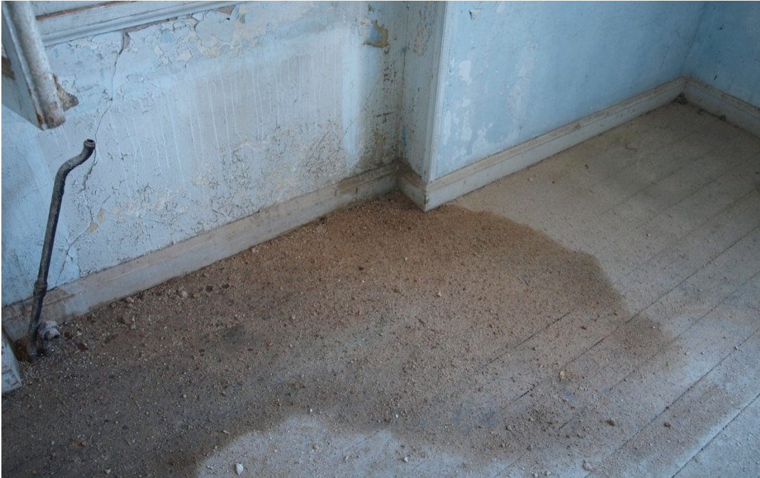
Εικόνα 38.Υγρασία σε δωμάτιο του ορόφου
