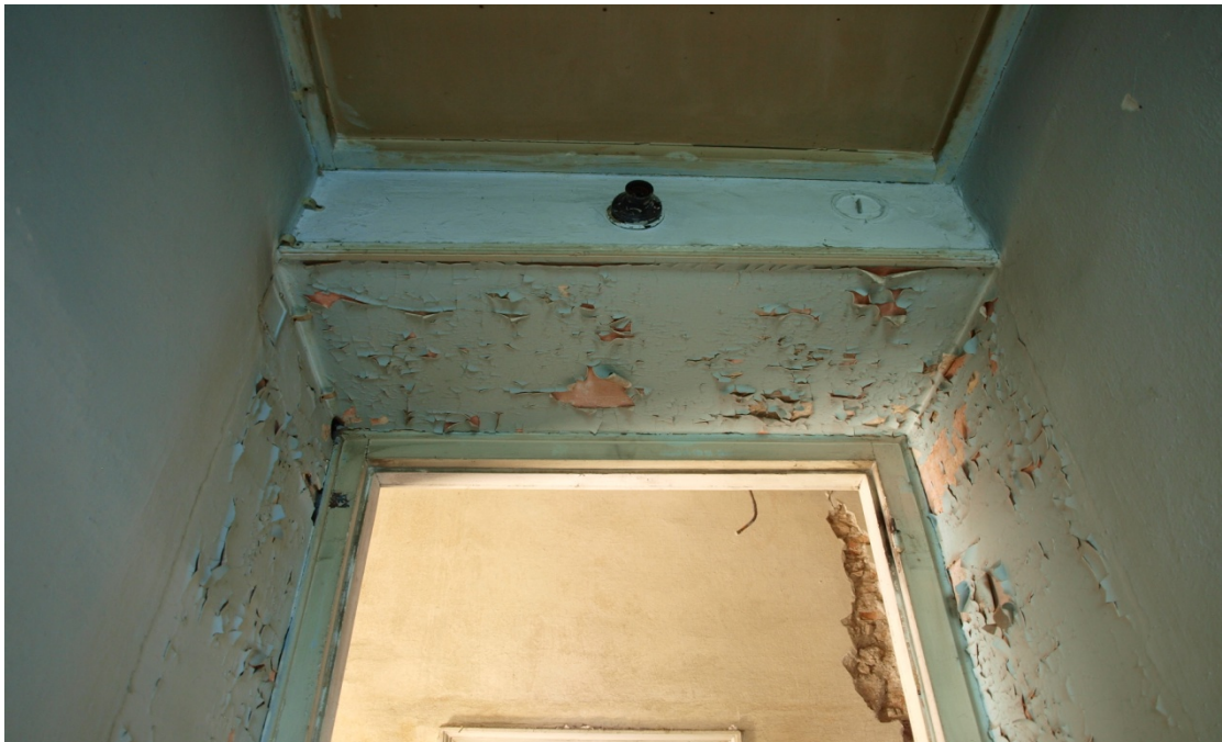
Εικόνα 25.Αποσάθρωση πλαστικού χρώματος σε αποθήκη του ορόφου
