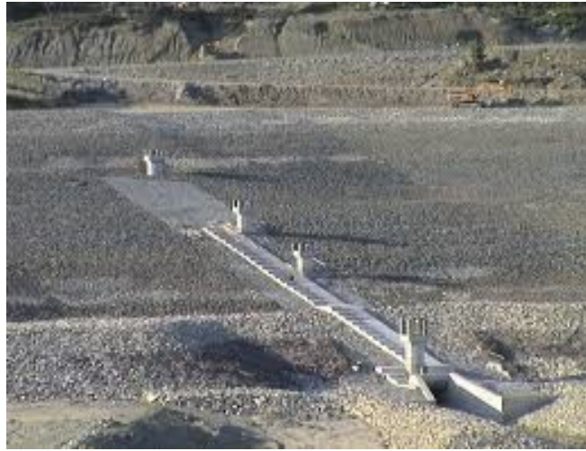
Εικόνα 1.3 : Στόμιο εκκένωσης και υδροληψίας
