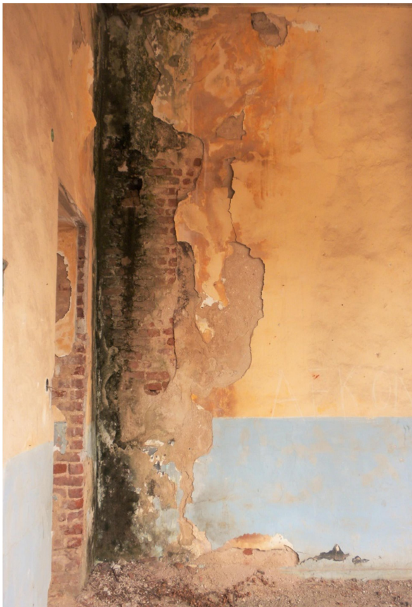
ΕΙΚ. 83 Εμφάνιση υγρασίας και βακτηρίων στην ένωση των τοιχοδομών.
