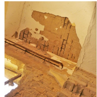
ΕΙΚ. 67 Αποκόλληση επιχρίσματος και οξείδωση μεταλλικού πλέγματος στην οροφή .
