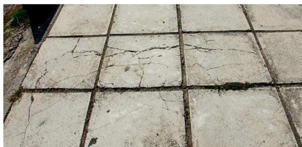
ΕΙΚ. 45 Τσιμεντόπλακες του εξωτερικού χώρου με ρηγματώσεις
