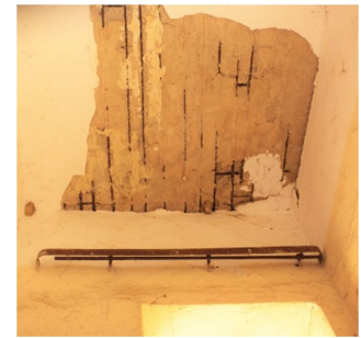
ΕΙΚ. 64 Αποκόλληση επιχρίσματος και οξείδωση μεταλλικού πλέγματος (στην οροφή .
