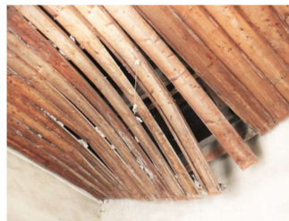
ΕΙΚ. 40 Διάβρωση ξύλινων σανίδων -ραμποτέ.
