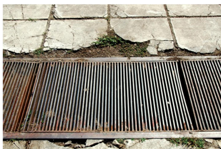
ΕΙΚ. 44 Κατεστραμμένες τσιμεντόπλακες στον εξωτερικό χώρο.
