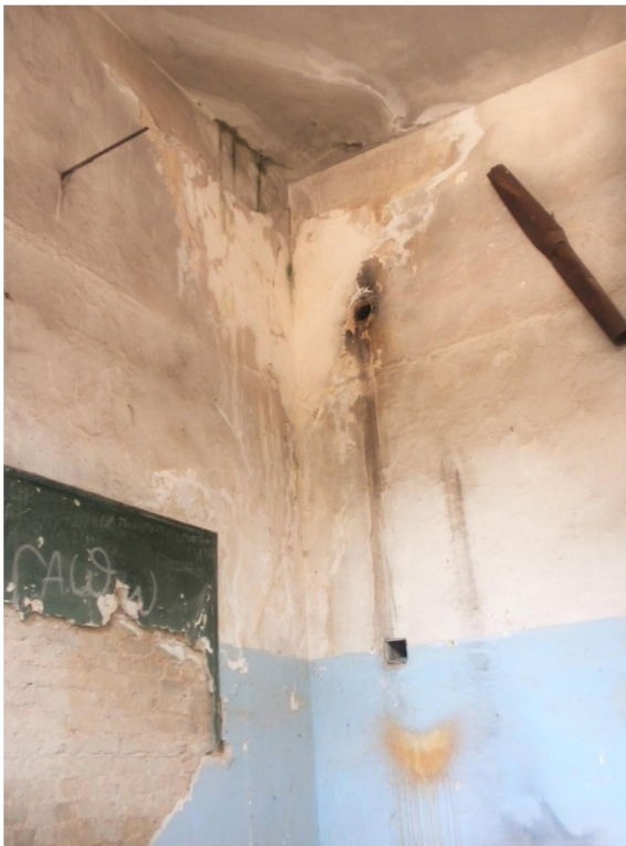
ΕΙΚ. 57 Εμφάνιση υγρασίας στην ένωση τοιχοποιιών.
