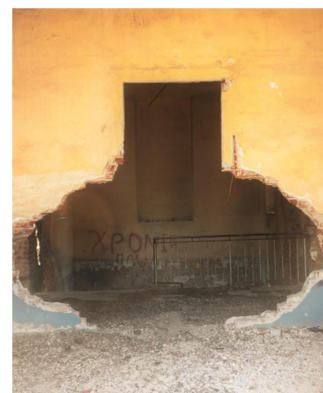
ΕΙΚ. 43 Κατάρρευση της τοιχοποιίας πλήρωσης στον όροφο.
