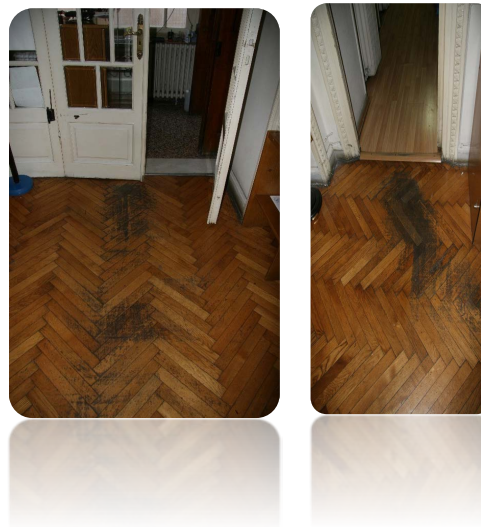
Εικόνα 56: Φθορές στα δάπεδα
