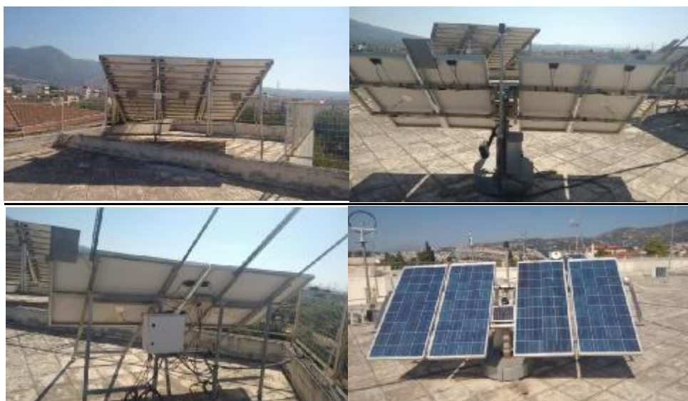
Εικόνα 7 Φωτοβολταϊκά πλαίσια στην οροφή του ΕΡΓΑΣΤΗΡΙΟΥ ΑΝΑΝΕΩΣΙΜΩΝ ΠΗΓΩΝ ΕΝΕΡΓΕΙΑΣ - ΤΜΗΜΑ ΜΗΧΑΝΟΛΟΓΙΑΣ -ΤΕΙ ΔΥΤΙΚΗΣ ΕΛΛΑΔΑΣ
