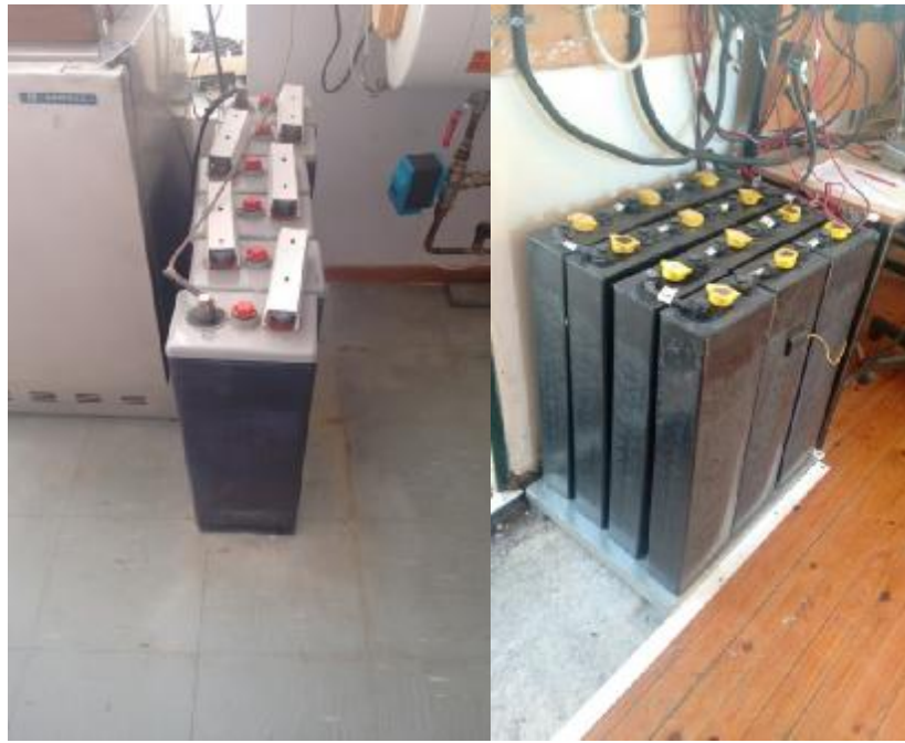
Εικόνα 4 Συσσωρευτές από το ΕΡΓΑΣΤΗΡΙΟ ΑΝΑΝΕΩΣΙΜΩΝ ΠΗΓΩΝ ΕΝΕΡΓΕΙΑΣ - ΤΜΗΜΑ ΜΗΧΑΝΟΛΟΓΙΑΣ -ΤΕΙ ΔΥΤΙΚΗΣ ΕΛΛΑΔΑΣ
