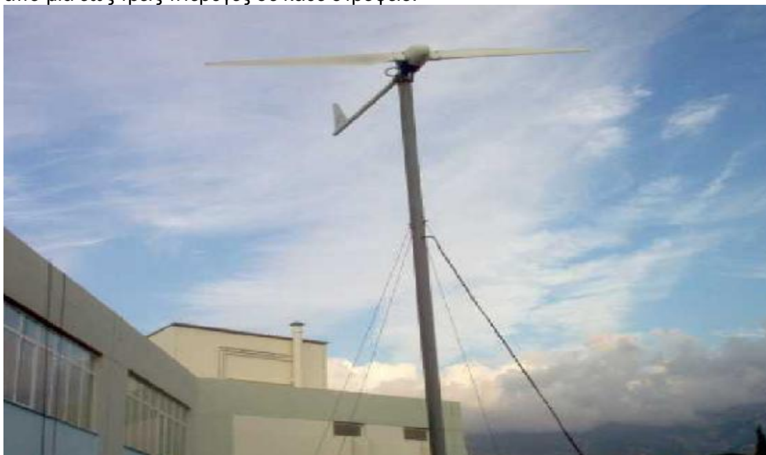
Εικόνα 13 Δίπτερη ανεμογεννήτρια 1kw από το ΕΡΓΑΣΤΗΡΙΟ ΑΝΑΝΕΩΣΙΜΩΝ ΠΗΓΩΝ ΕΝΕΡΓΕΙΑΣ - ΤΜΗΜΑ ΜΗΧΑΝΟΛΟΓΙΑΣ -ΤΕΙ ΔΥΤΙΚΗΣ ΕΛΛΑΔΑΣ
