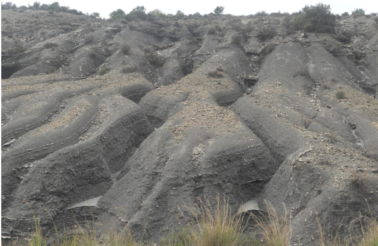
Εικόνα 6 Αυλακωτή διάβρωση σε πρανές σε επαρχιακή οδό Αντιρρίου – Θέρμου. Πηγή: Προσωπικό αρχείο
