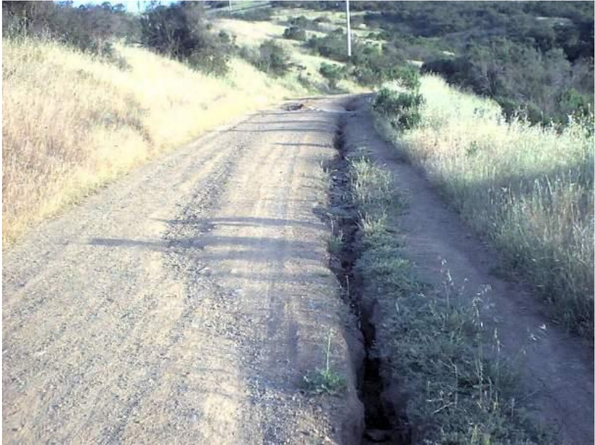
Εικόνα 26 Αυλακωτή διάβρωση σε πάρκο στην Σάντα Τερέζα, Καλιφόρνια, ΗΠΑ. Πηγή: stpfriends.org
