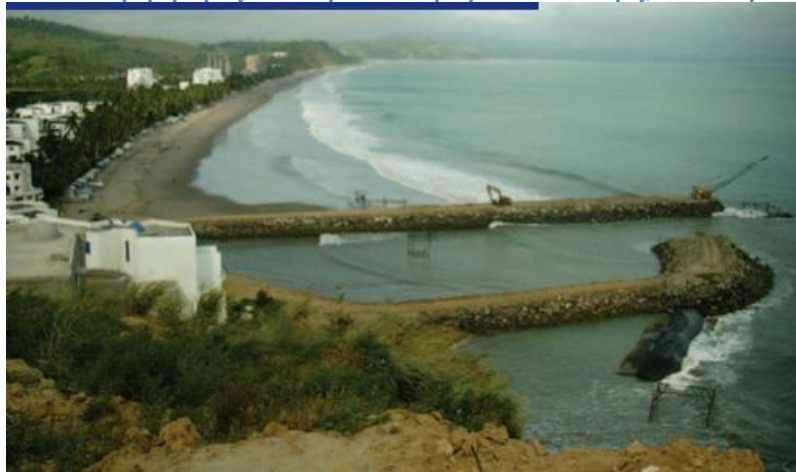
Εικόνα 53 Οι προβλήτες μετά την ολοκλήρωση των εργασιών, Στέλλα Μαρίς, Εκουαδόρ. Πηγή: tencate.com
