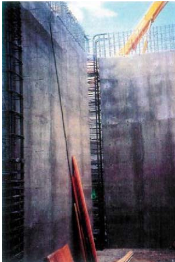
Εικόνα 3.19 Διαστρωμένη επιφάνεια εκτοξευόμενου σκυροδέματος σε τοίχους, πριν κατασκευή των ακραίων υποστυλωμάτων. Διακρίνονται και τα μεταλλικά ελάσματα που βοηθούν τη διάστρωση [7]
