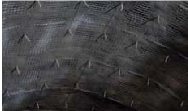
Εικόνα 3.9 Το πλέγμα που χρησιμοποιήθηκε στο έργο της σήραγγας του Lungern για τον περιορισμό της αναπήδησης, κατά τη φάση της σκυροδέτησης του κανάβου [22].
