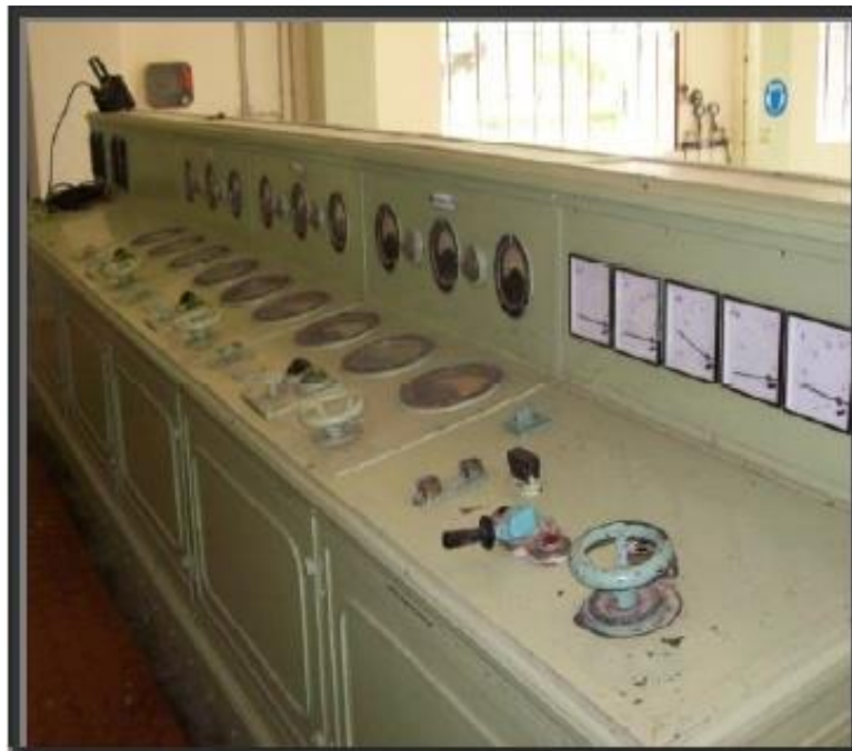
Εικόνα 76: παλιός πίνακας ελέγχου
