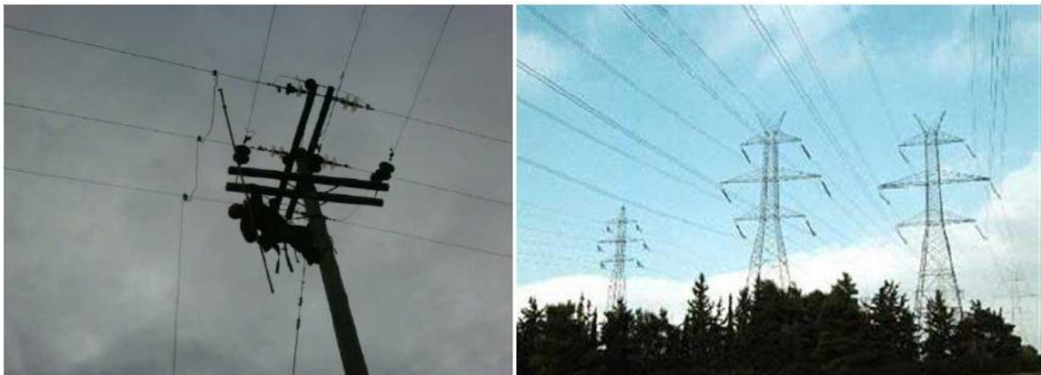
Εικόνα 25: κολώνα μέσης τάσεως(αριστερά)και πυλώνες υψηλής τάσεως
