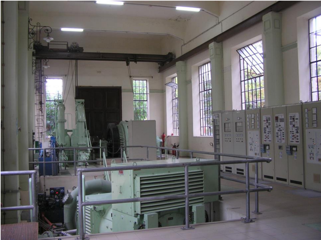
Εικόνα 18: Εσωτερική άποψη σταθμού. Στα δεξιά της φωτογραφίας ο πίνακας ελέγχου και στο βάθος ο στρόβιλος Pelton
