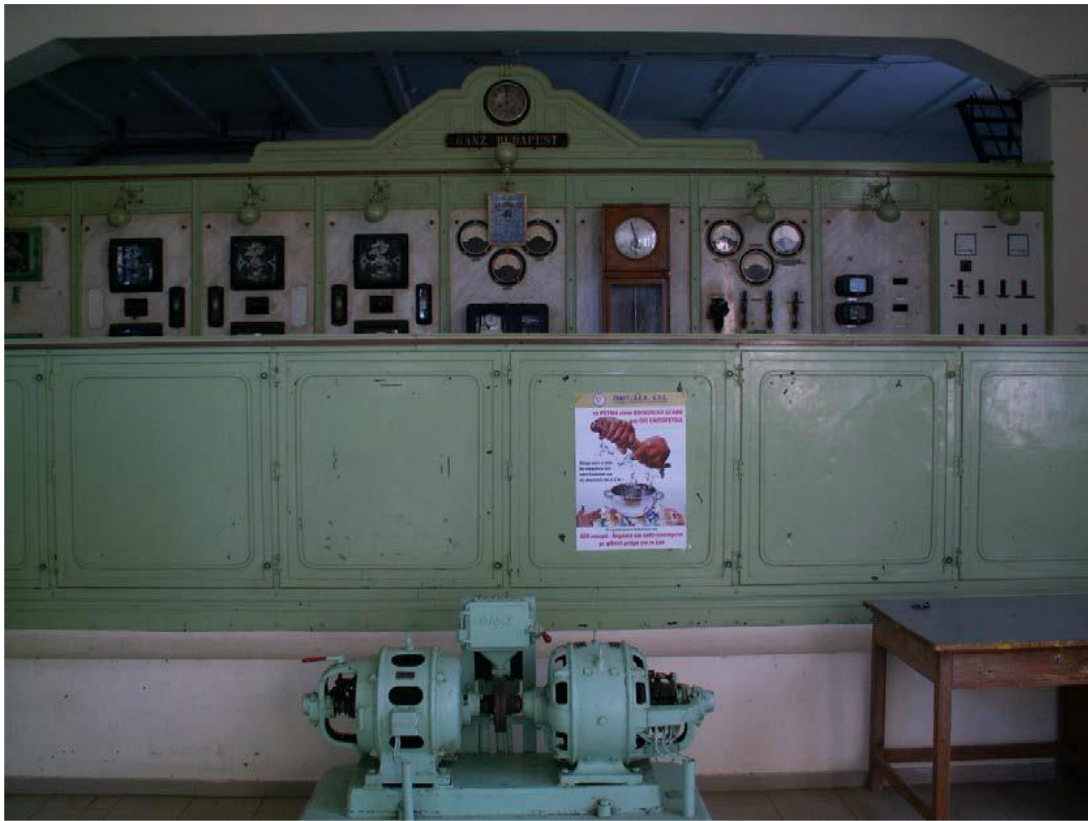
Εικόνα 75: παλιός πίνακας ελέγχου
