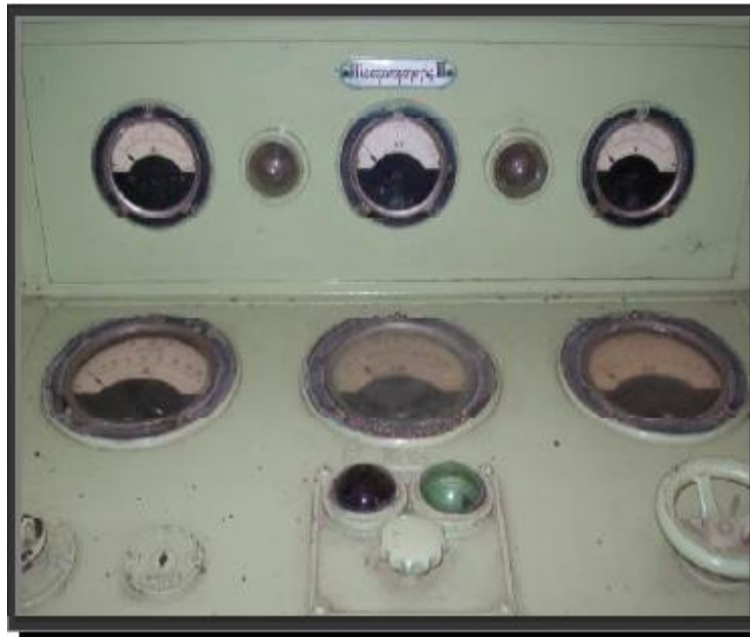
Εικόνα 77: παλιός πίνακας ελέγχου
